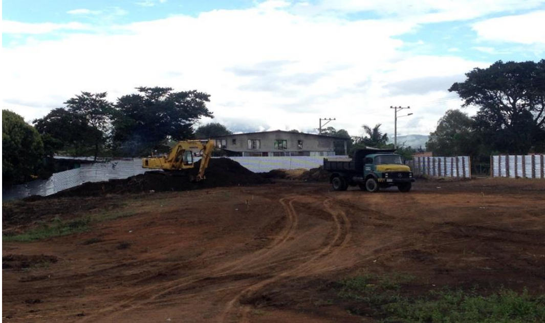
Figura 17. Desalajo de tierra negra con volquetas en viajes internos. Fuente: Elaboración propia.
