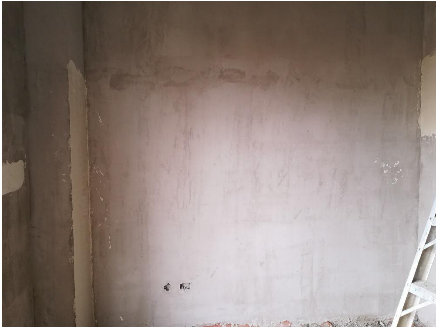
Figura 29. Pañete de muro con relleno en muro. FUENTE. Propia.
