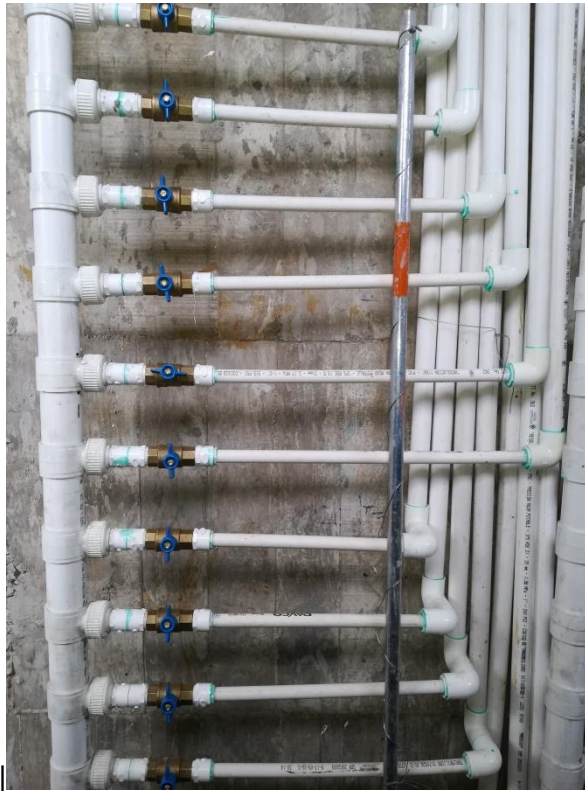
Figura 37. Muñeco del gabinete de medidores apartamentos primer piso. FUENTE. Propia.
