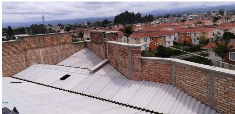
Figura 26. Tejas de fibrocemento a dos aguas llegando a un canal de recolección de aguas lluvias.
