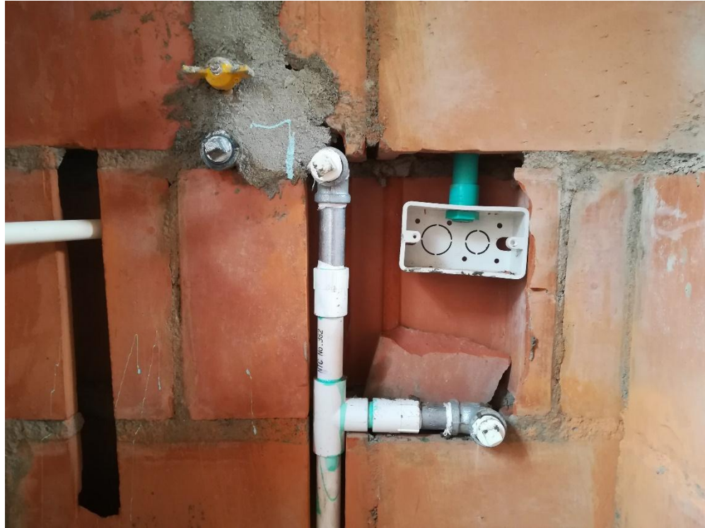
Figura 24. Tomacorriente de lavadora. FUENTE. Propia.
