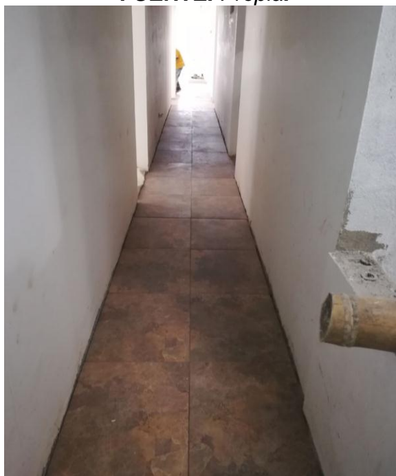
Figura 44. Piso sin fragua ni guarda escobas en zonas comunes. FUENTE. Propia.
