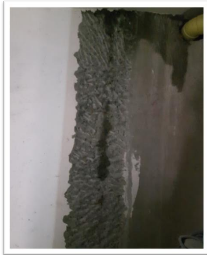
Figura 33. Resane de Muro por presencia de Rebaba. Fuente: Propia (2017).
