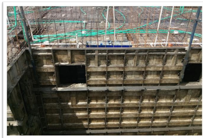
Figura 12. Formaleta Tipo Forsa Apartamentos Torre C. Fuente: Propia (2017).
