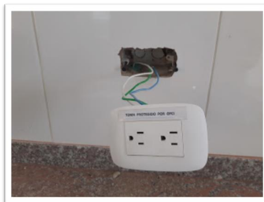
Figura 30. Toma Protegido por GFCI. Fuente: Propia (2017).
