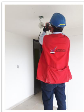
Figura 29. Pruebas de Voltaje en acometidas eléctricas. Fuente: Propia (2017).
