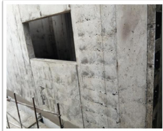
Figura 15. Inspección Visual Torre C-Flejes con poco Recubrimiento. Fuente: Propia (2017).
