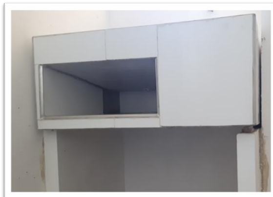
Figura 26. Mal apoyo Lavarropas. Fuente: Propia (2017).
