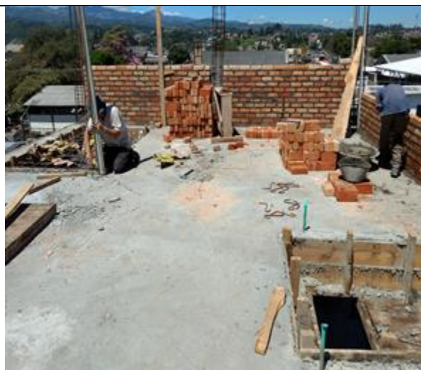
Imagen 41. Losa de cuarto piso, no aprobada por curaduría, fuente propia.
