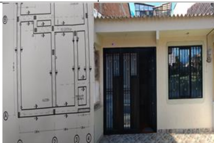
Imagen 20. Faltante de muro de concreto d en el eje A entre 3 y 4, fuente propia.
