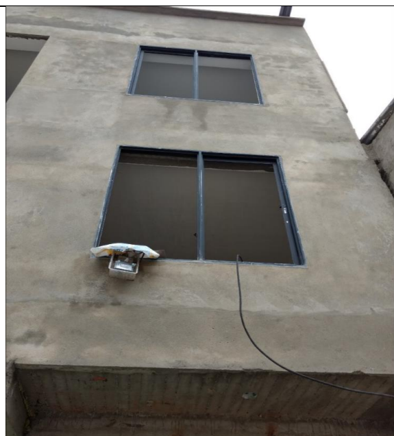
Imagen 59. Omisión de la construcción de balcones propuestos en los planos, fuente propia.
