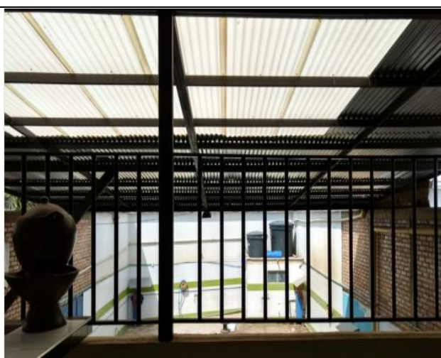
Imagen 24. Estructura metálica no descrita en los planos, fuente propia.
