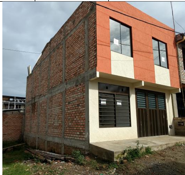
Imagen 70. Adición de un piso no aprobado por curaduría urbana No.2, fuente propia.
