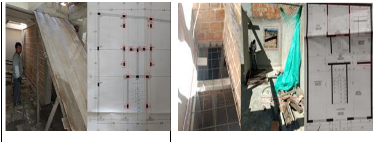
Imagen 47. Modificación en el número de columnas construidas en la obra, fuente propia.
