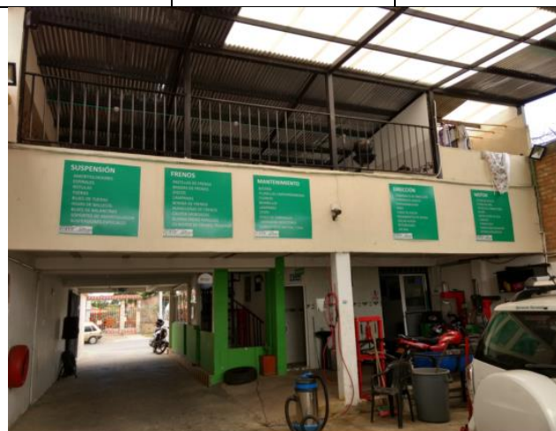
Imagen 21. Adición de un segundo piso que no se encuentra en la licencia, fuente propia.
