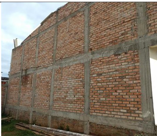
Imagen 71. Disposiciones estructurales no descritas en planos aprobados, fuente propia.
