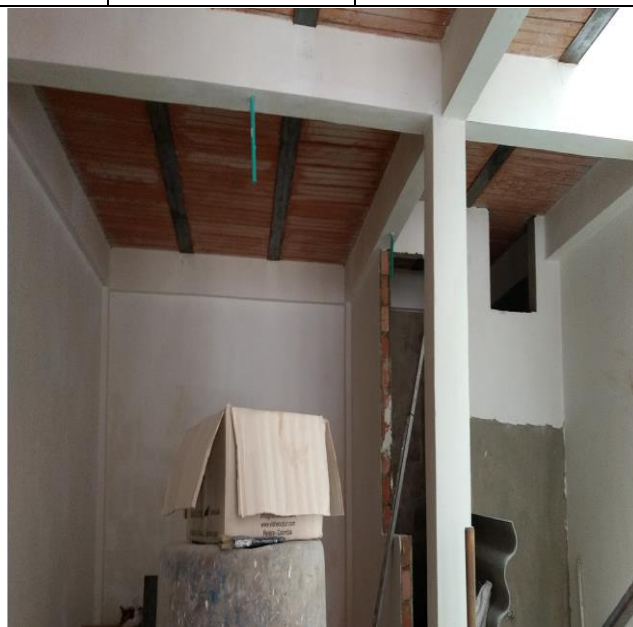
Imagen 66. Faltante del vacío ejes A-E, 5-6, fuente propia.
