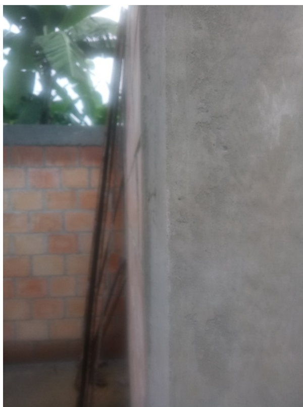
Fig 21: Columna con malos acabados
