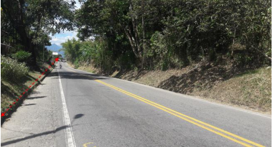
Fotografía No.9. Instalación de tubería sanitaria PVC de 8" paralela a la vía Mojarras – Popayán entre PR73+250 y PR73+700 margen izquierda.
