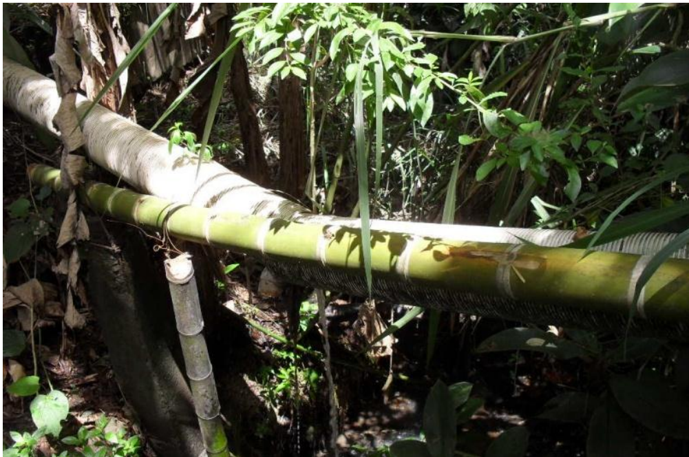
Fotografía No.3. Estado actual de la tubería sanitaria
