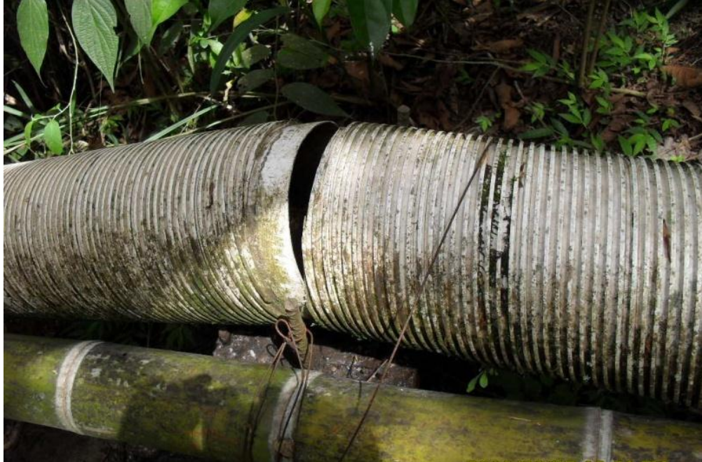
Fotografía No.2. Estado actual de la tubería sanitaria.
