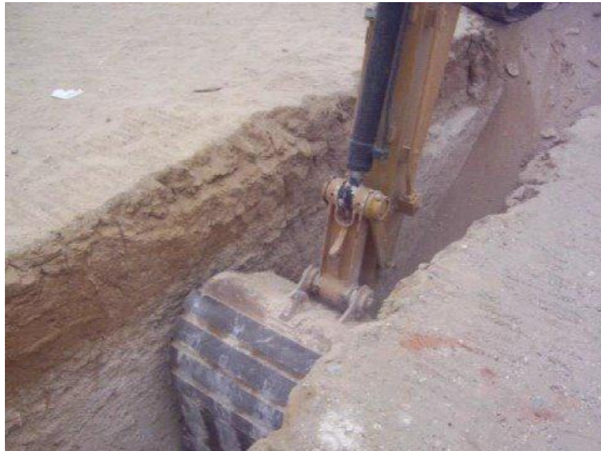
Figura No. 9. Ejemplo de excavación de zanjas para instalación de tubería a máquina.
