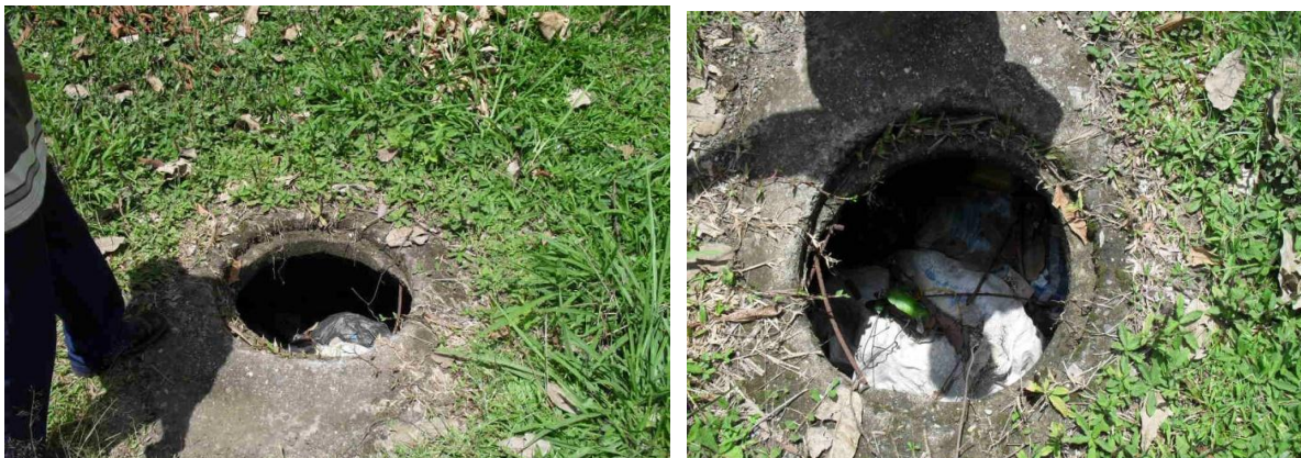
Fotografía No.4. Pozos de inspección en mal estado.
