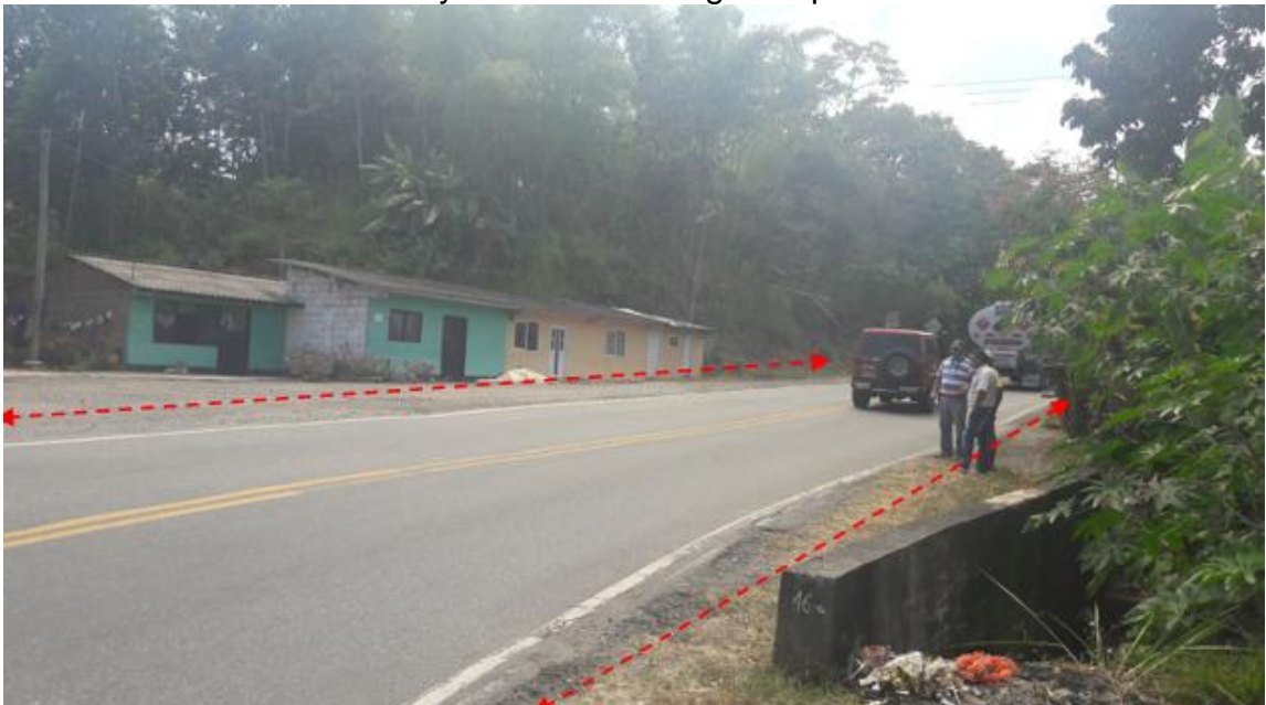
Fotografía No.6. Instalación de tubería sanitaria PVC de 8" paralela a la vía Mojarras – Popayán entre PR73+700 margen derecha y PR72+850 y entre PR73+700 y PR72+900 margen izquierda.
