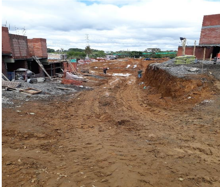
Figura 7. Estado de vía manzana H.
