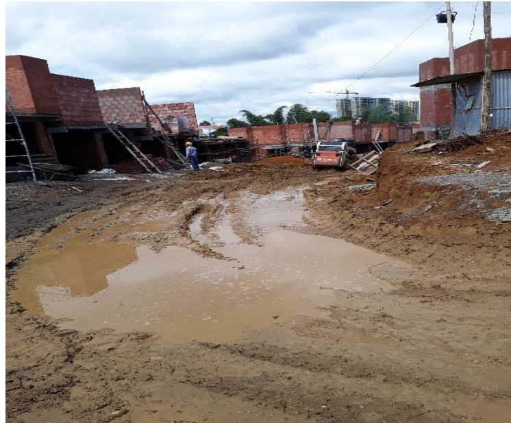
Figura 8. Estado de vía manzana F-G.
