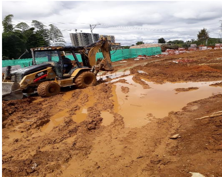
Figura 10. Estado de vía manzana J.
