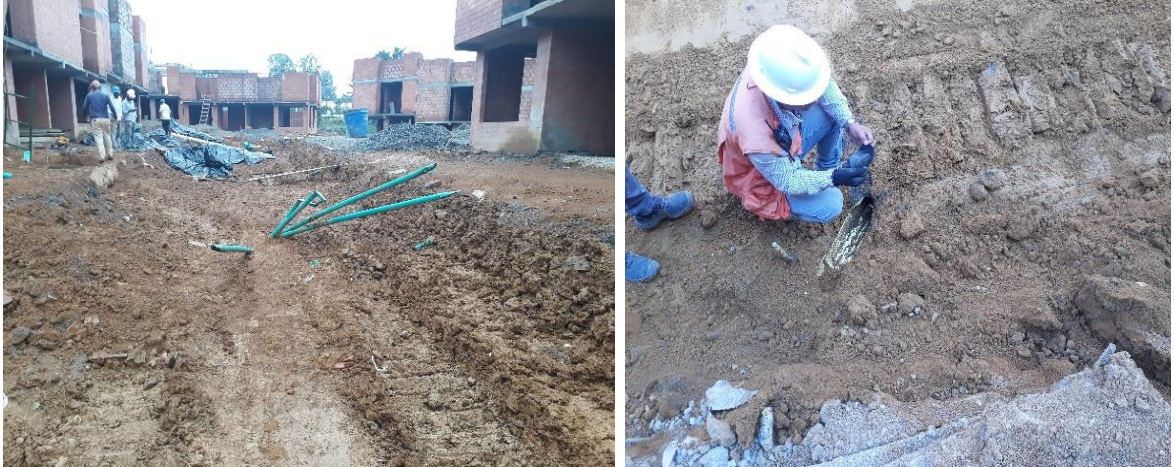
Figura 25. Daño en tuberías.
