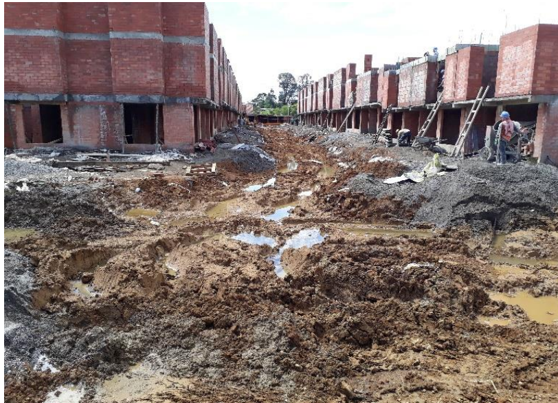
Figura 6. Estado de vía manzana G.
