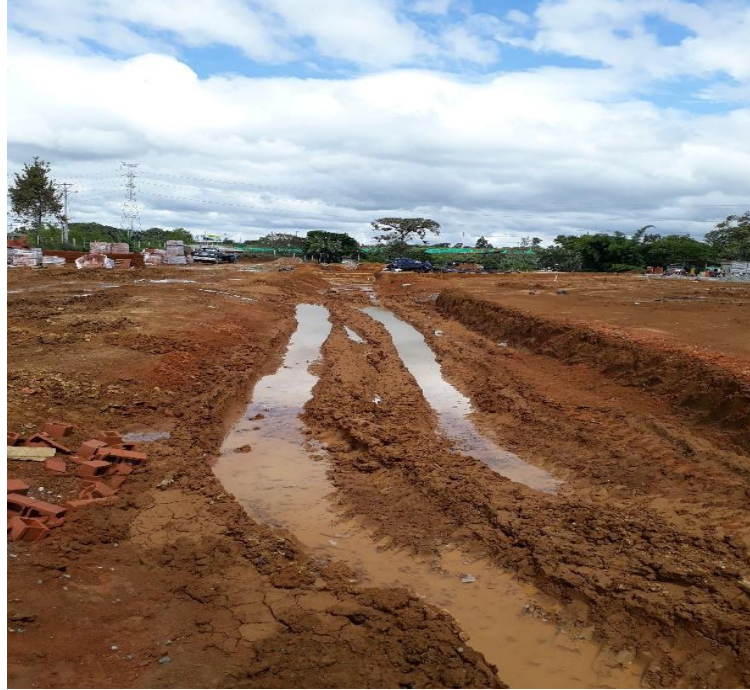
Figura 9. Estado de vía manzana I.
