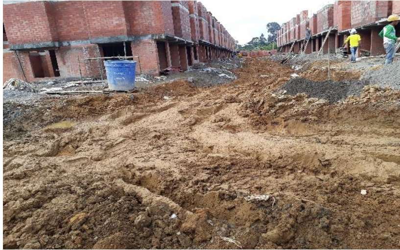
Figura 5. Estado de vía manzana G.
