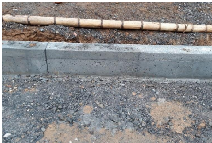
Figura 52. Concreto mal vibrado
