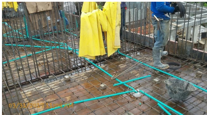
Fotografía 16. Vista superior del refuerzo de la losa del apartamento. Fuente: Tomada por el pasante
