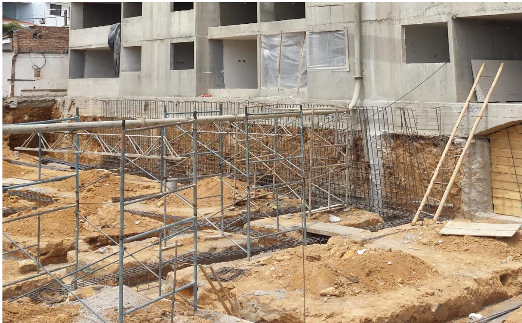
Fotografía 41. Excavación de cimentación de locales comerciales, vista frontal. Fuente: Tomada por el pasante
