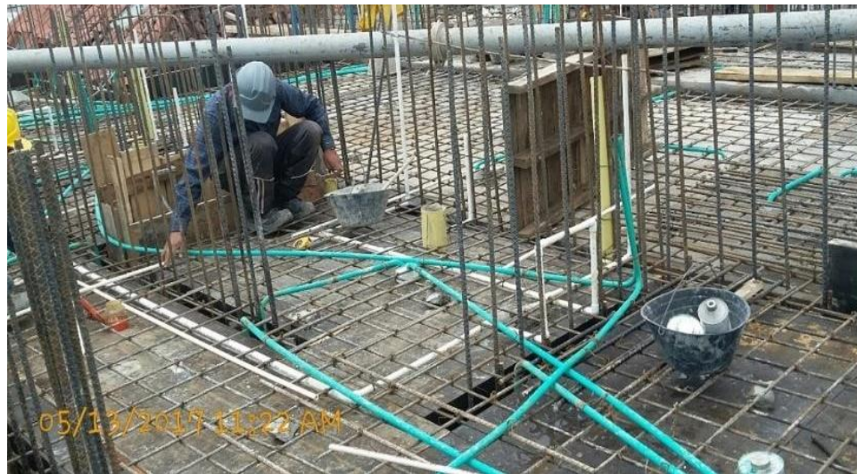
Fotografía 21. Instalaciones hidráulicas y eléctricas del apto 2. Fuente: Tomada por el pasante
