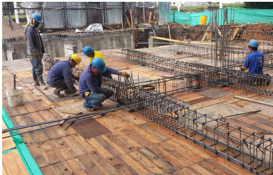
Fotografía 56. Armado de refuerzo de acero de vigas sobre entarimado. Fuente: Tomada por el pasante
