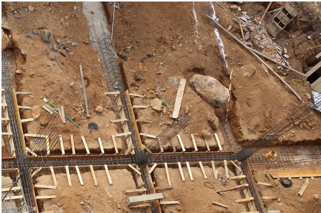
Fotografía 46. Roca grande interfiriendo con la excavación de la cimentación.
