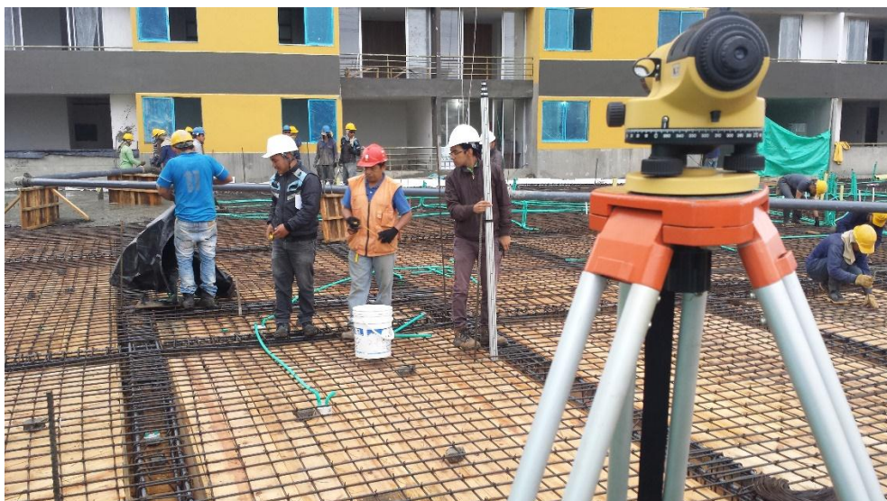
Fotografía 62. Nivelación de la losa mediante nivel de precisión. Fuente: Tomada por el pasante
