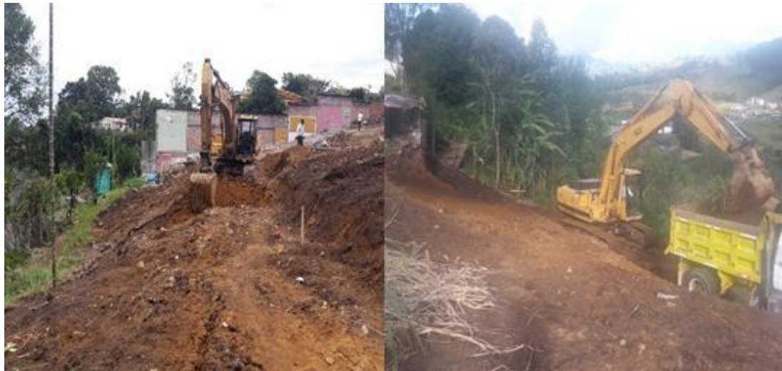
Fotografía 3. Se procede a la excavación de material. Fuente: Tomada por el ingeniero residente
