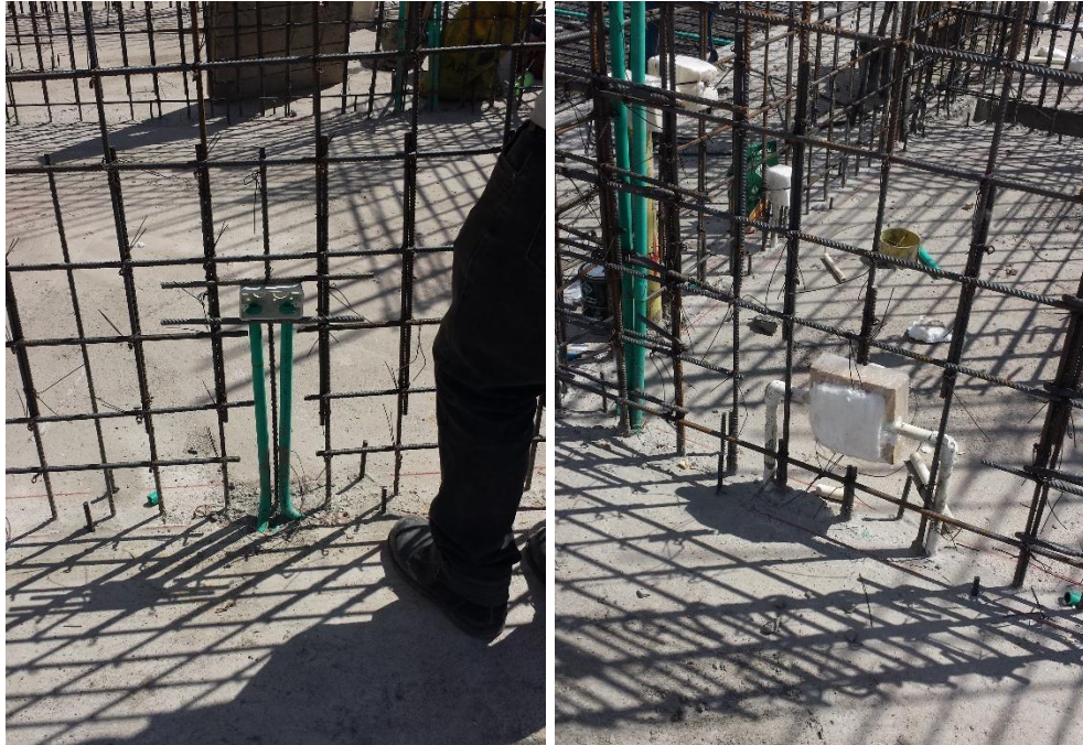
Fotografía 10. Instalación de tomas eléctricos y cajillas hidráulicas. Fuente: Tomada por el pasante
