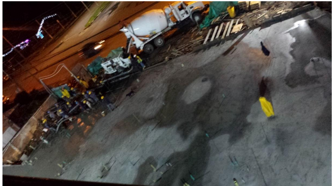
Fotografía 65. Fundición de la losa en su totalidad. Fuente: Tomada por el pasante
