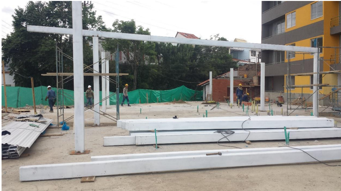
Fotografía 68. Instalación de vigas metálicas para locales comerciales. Fuente: Tomada por el pasante
