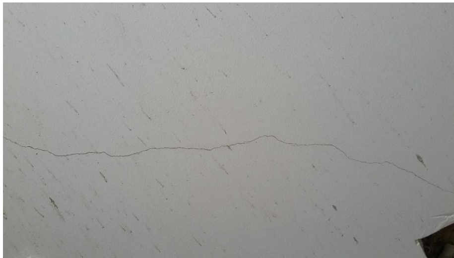
Fotografía 40. Fisuras en los acabados. Fuente: Tomada por el pasante
