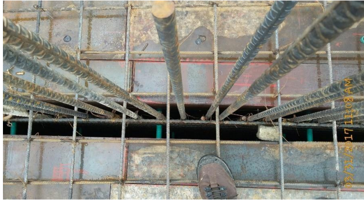
Fotografía 17. Ubicación del refuerzo sobre el muro antes de la fundición. Fuente: Tomada por el pasante
