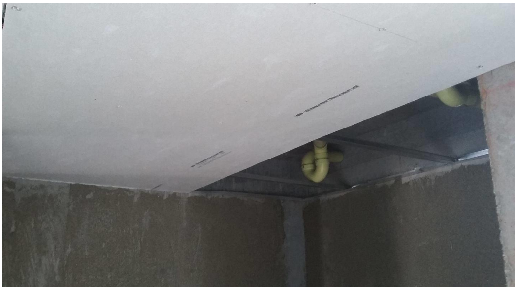
Fotografía 71. Instalación de superboard como cielo de baños y cocina. Fuente: Tomada por el pasante
