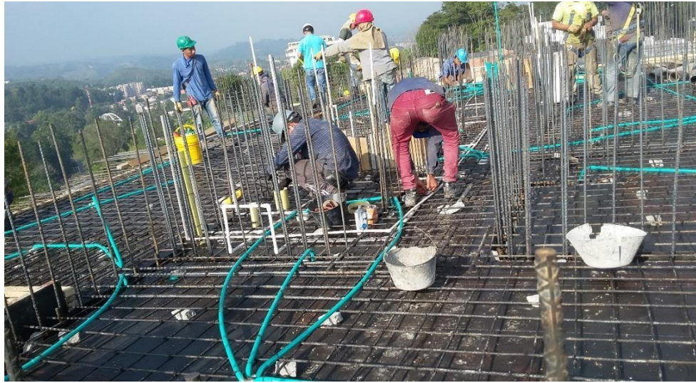
Fotografía 34. Instalaciones hidráulicas y eléctricas del 10mo piso. Fuente: Tomada por el pasante
