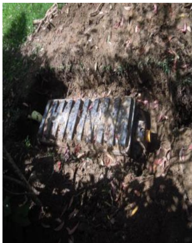
FIGURA 29. Trampa de grasas plástica y Tanque séptico integrado 1650L (Ítems 4,11 y 4,12).
