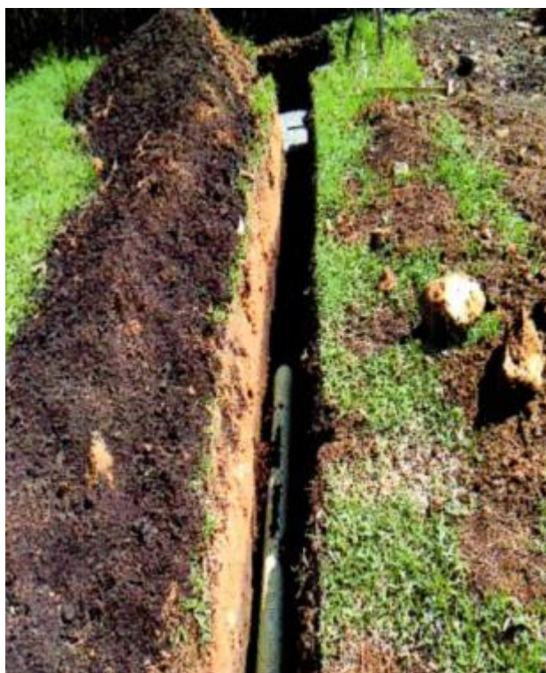
FIGURA 66. Tubería PVC Novafort 6" para conducción de aguas lluvias hacia el descole.
