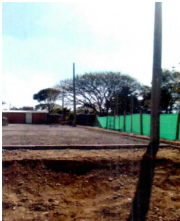
FIGURA 64. Poste en concreto y Reflector metal halide 400W. (Ítem 3,2 y 3,1).
