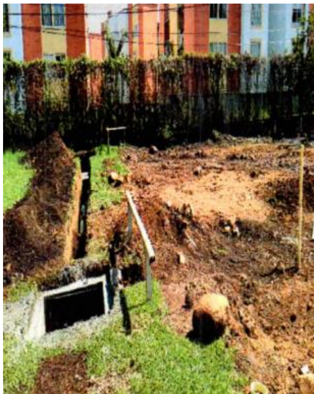
FIGURA 65. Caja de distribución para recolección de aguas lluvias de canaleta y filtros.
