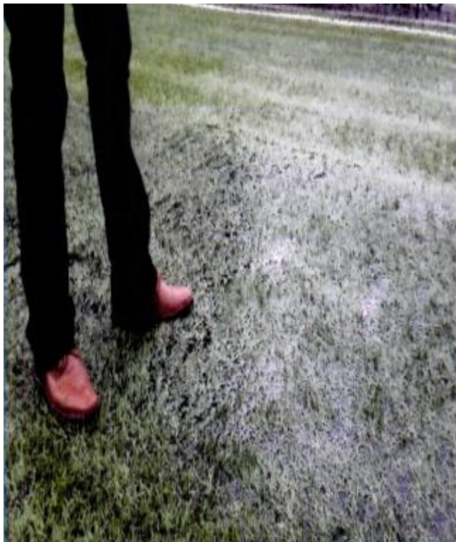
FIGURA 71. Empozamientos de agua lluvia en la cancha después de instalado el césped sintético.
