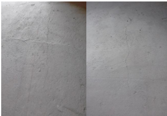
Imagen 80. Fisuras en el apartamento 207 – Torre 4 – Bloque B, fuente propia
