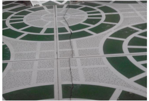
Imagen 102. Grietas en la losa del primer piso, fuente propia
