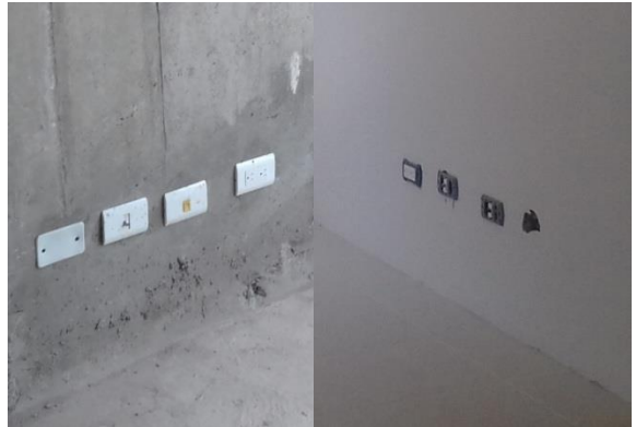
Imagen 83. Revisión de las instalaciones eléctricas, fuente propia
