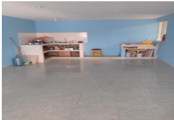
Imagen 70. Faltante de alcoba ubicada entre los ejes 1-2 y A-B', fuente propia
