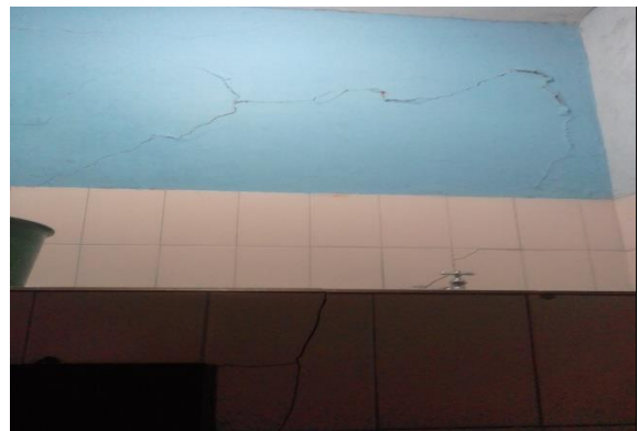
Imagen 99. Grietas en los baños del primer piso, fuente propia
