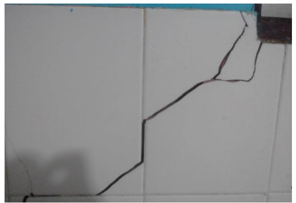
Imagen 100. Grietas en uno de los muros del primer piso, fuente propia
