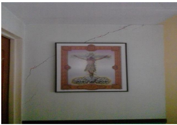
Imagen 100. Grietas en uno de los muros del segundo piso, fuente propia
