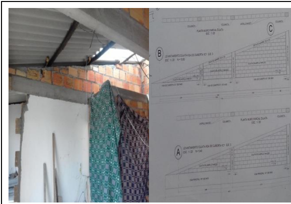
Imagen 46. Faltante de columnetas y cintas de amarre de culatas, fuente propia
