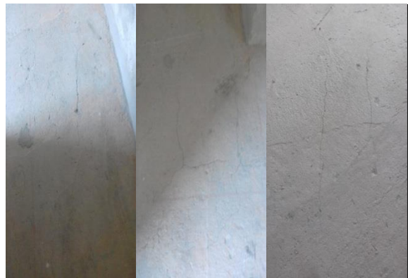
Imagen 81. Fisuras en el apartamento 506 – Torre 4 – Bloque B, fuente propia
