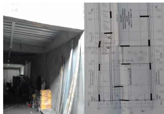
Imagen 62. Faltante del vacío comprendido entre los ejes 5-1 y A-D
