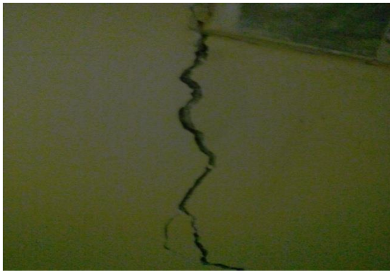
Imagen 101. Grietas en uno de los muros del segundo piso, fuente propia
