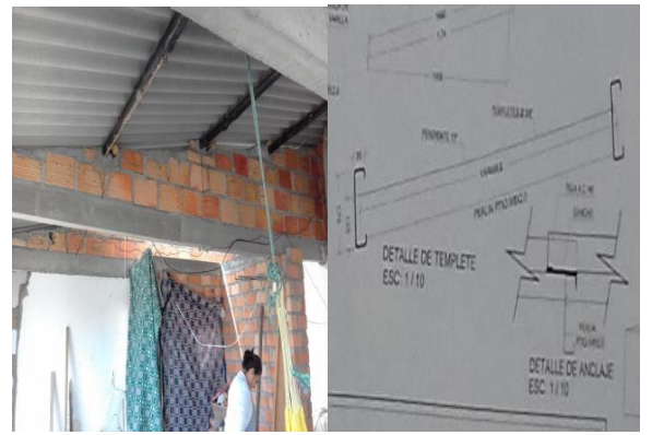
Imagen 47. Faltante de tensores o templetes, fuente propia
