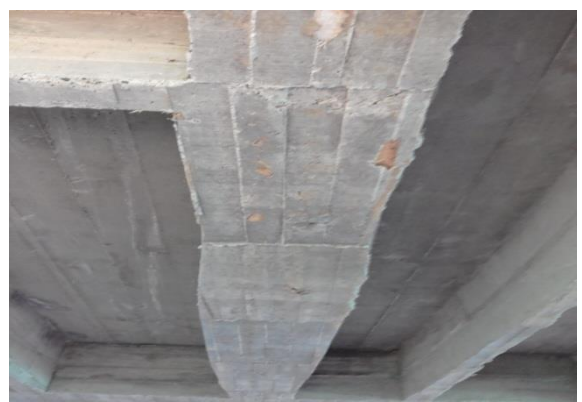
Imagen 23. Irregularidades en viga de entrepiso, fuente propia
