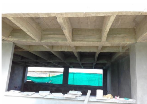
Imagen 22. Irregularidades en los nervios de la losa aligerada, fuente propia
