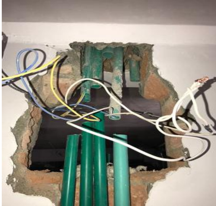
Figura 36. Perforación de vigas para instalaciones eléctricas
