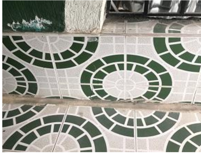
Figura 29. Fisuras en las baldosas del antejardín
