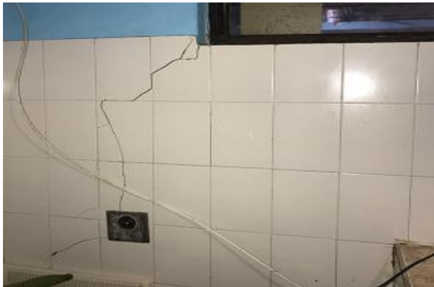
Figura 32. Fisuras en el enchape del baño
