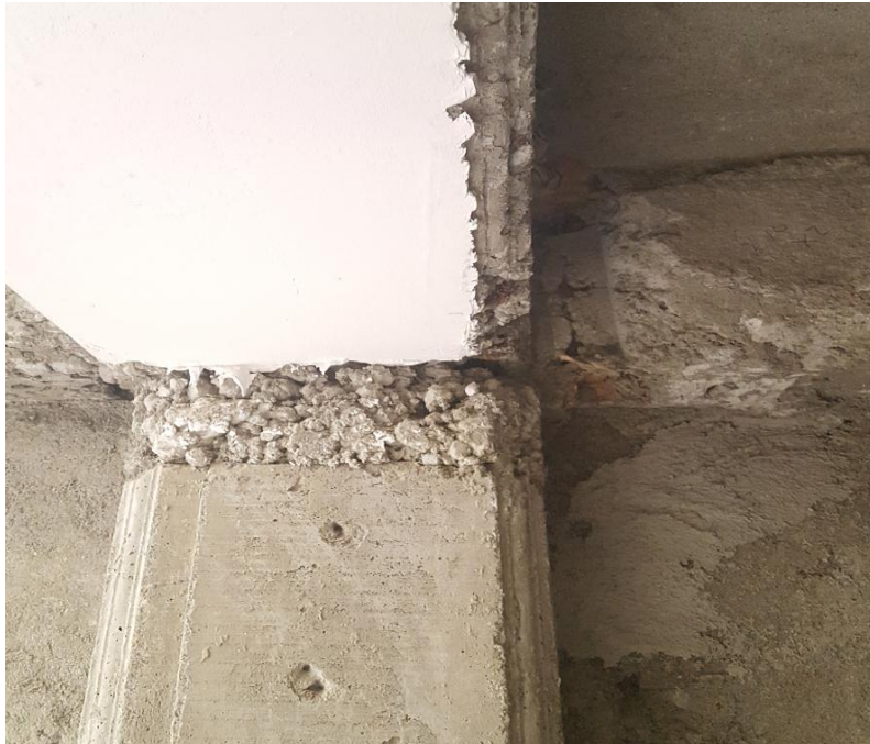
Figura 35. Hormiguno y segregación en vigas y columnas
