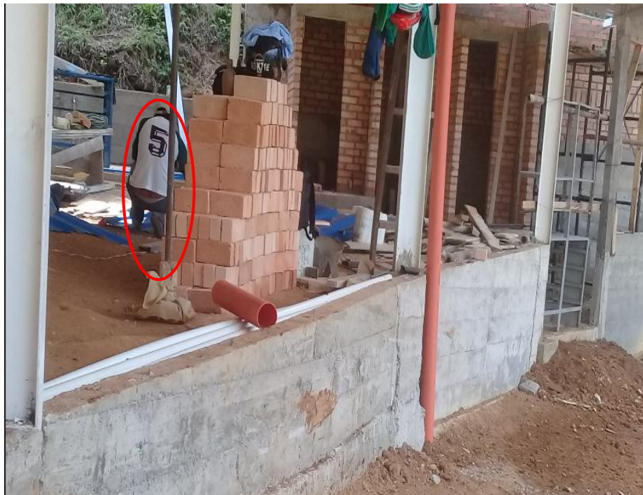
Figura 44. No hay elementos de protección para los obreros
