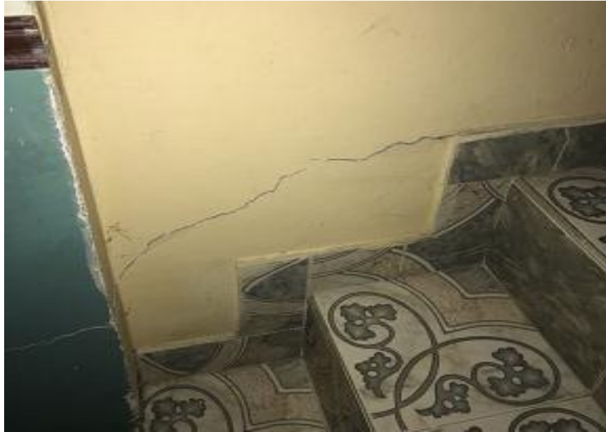
Figura 31. Grietas en los muros de las gradas
