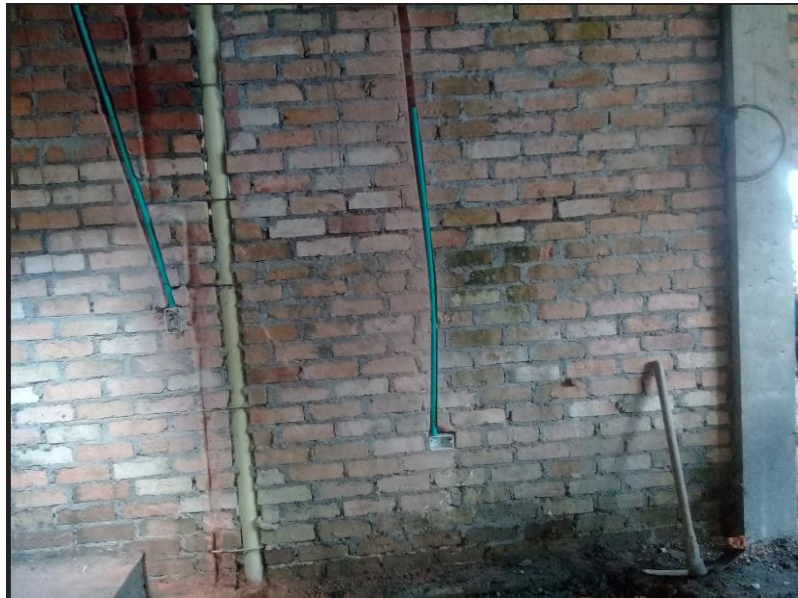
Figura 28. Muro sin columnetas de confinamiento
