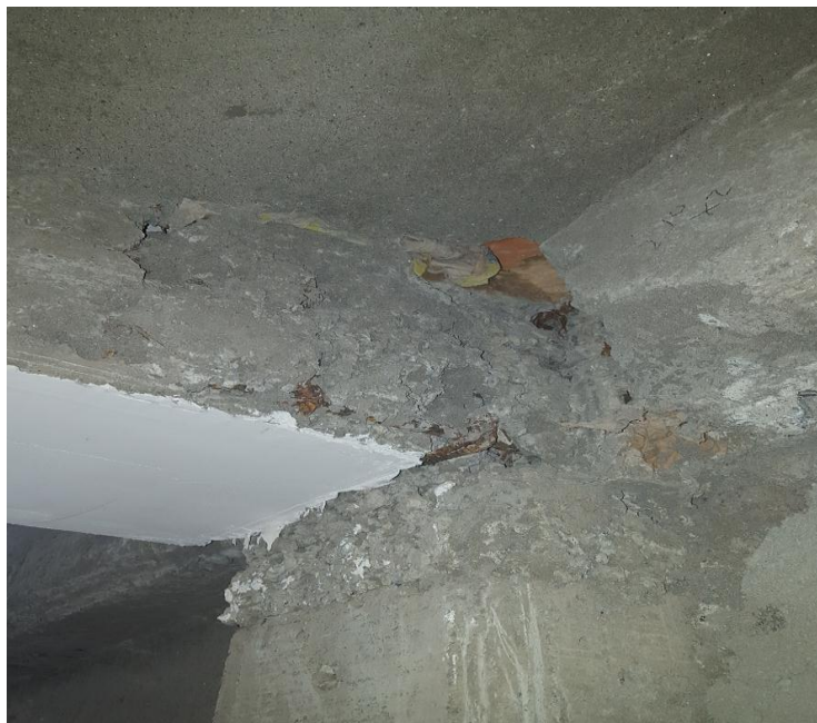
Figura 37. Falta de recubrimiento del acero
