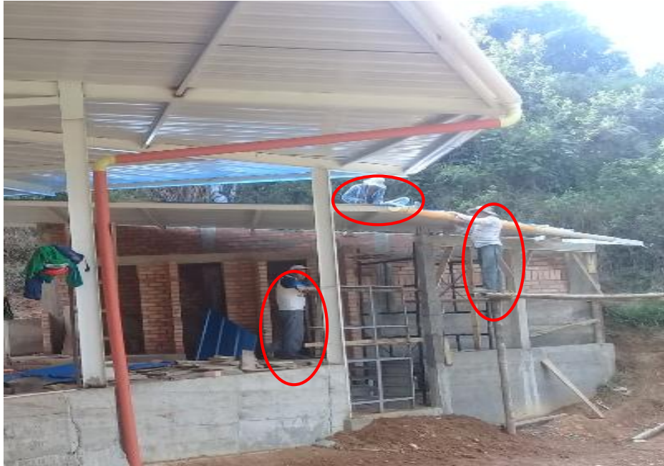
Figura 43. Trabajadores sin elementos de protección
