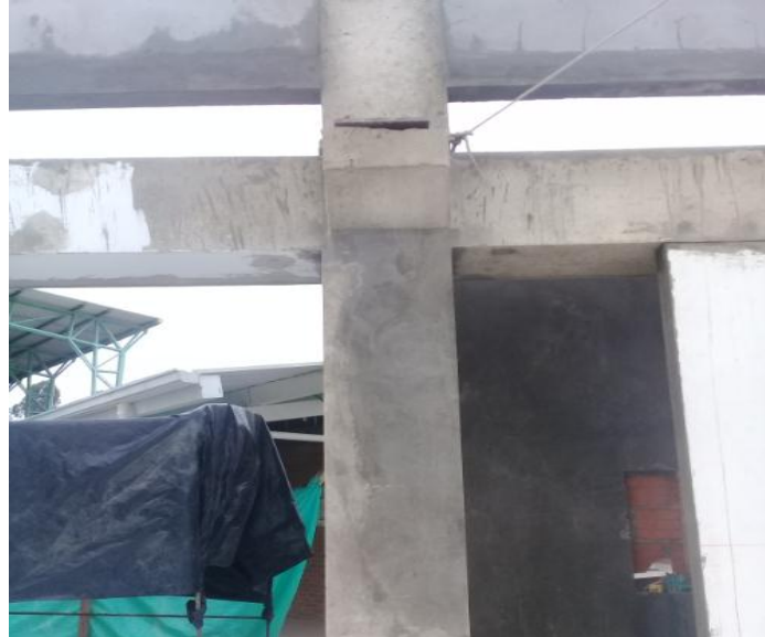
Figura 42. Hormigqueo en el concreto
