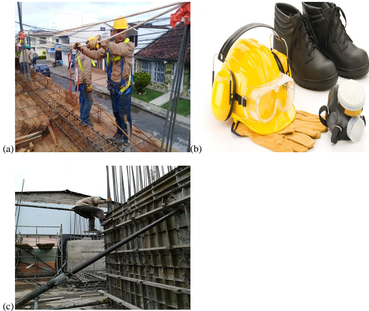
Figura 20: (a) Trabajadores con sus respectivos EPP, (b) Elementos de protección personal, (c) Trabajador sin ningún tipo de protección. (Fuente: Autor).
