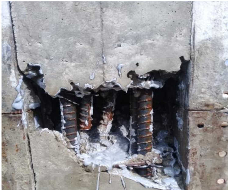
Figura 12: Muro Pantalla en concreto con hormigueros. (Fuente: Autor).
