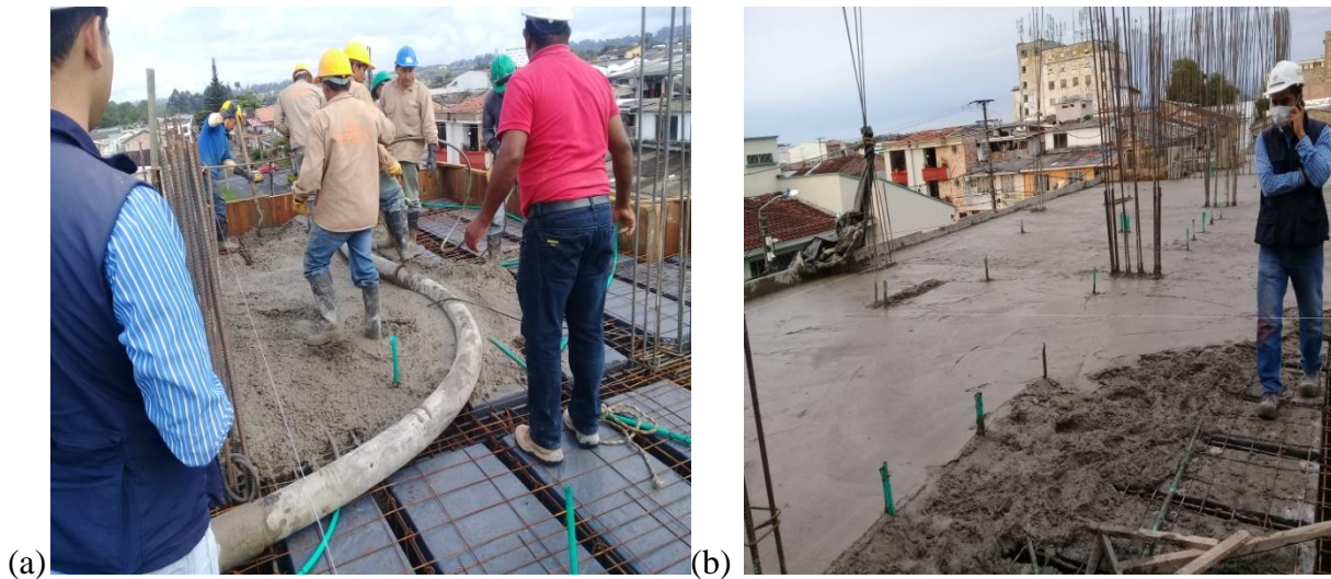
Figura 28: (a) Vaciado de concreto sobre vigas y losa de entrepiso, (b) Nivelación y terminado de losa de entrepiso. (Fuente: Autor).
