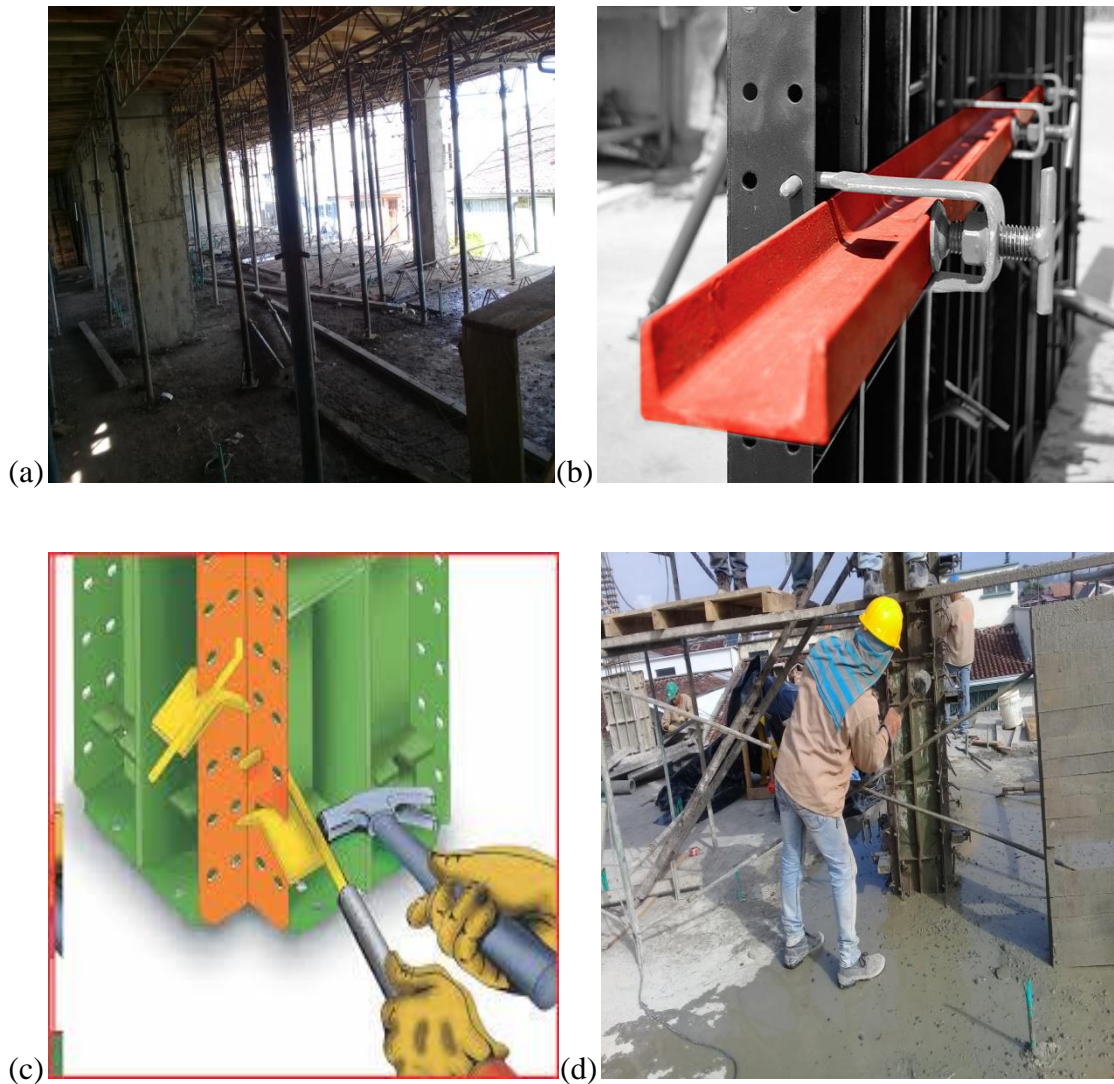
Figura 14: (a) Formaleta y encofrado para losa de entrepiso, (b) Alineadores, (c) Mordazas, (d) Formaleta y encofrado para columna. (Fuente: Autor).
