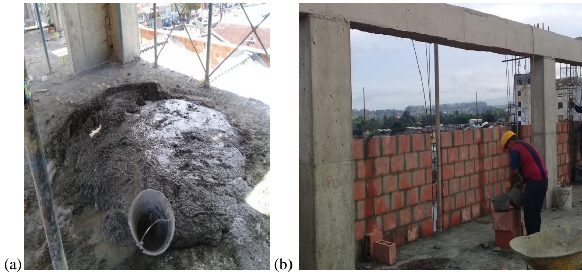
Figura 34: (a) Preparación de mortero de relleno (Grouting), (b) Vaciado de grouting sobre dovelas del muro. (Fuente: Autor).
