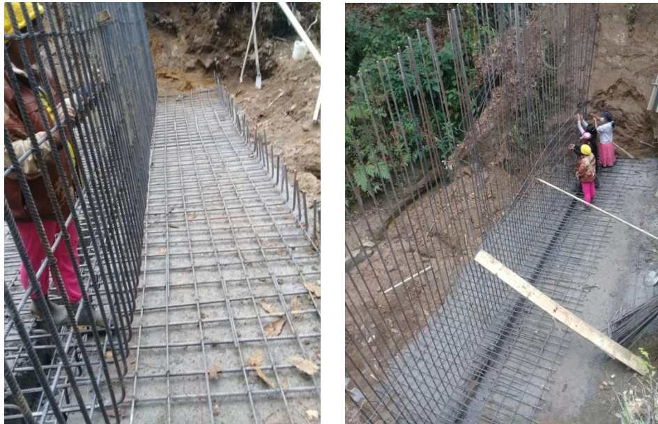
Ilustración 25. Formación del castillo de aceros para el muro de contención. Vereda Altamira.
