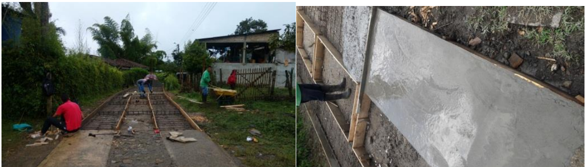
Ilustración 33. Aceros de refuerzo y fundición de la losa de placa huella in situ . Vereda Cajete.
