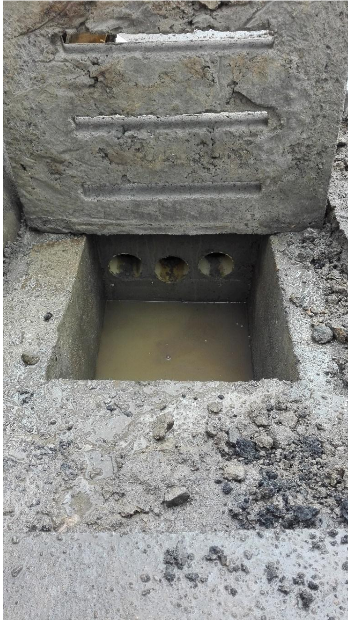
Fotografía 30: Funcionamiento del sumidero. Fuente: Tomada por Jhon Edison Ordoñez
