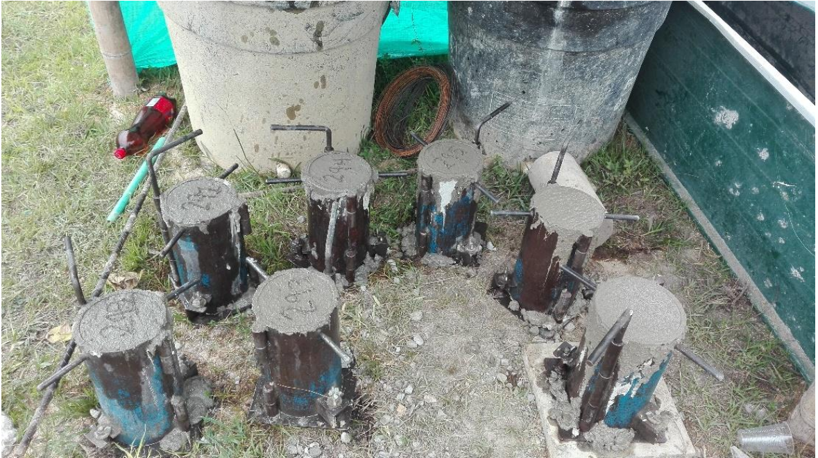
Fotografía 32: Fabricación de cilindros de compresión. Fuente: Foto tomada por Jhon Edison Ordoñez
