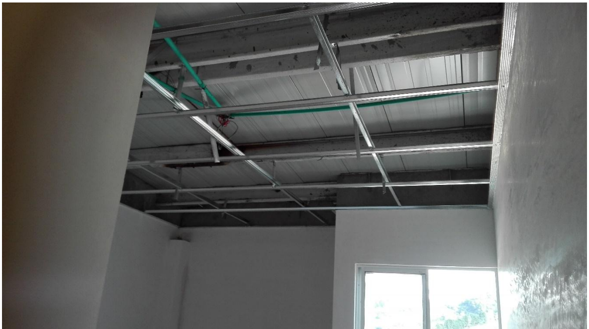
Fotografía 13: Estructura metálica que soporta el panel yeso. Fuente: Tomada por Jhon Edison Ordoñez
