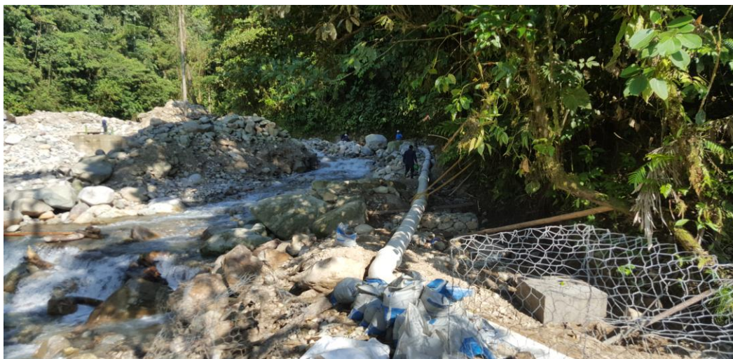
Figura 17. Línea de aducción que conduce de la bocatoma al tanque de derivación provisional
