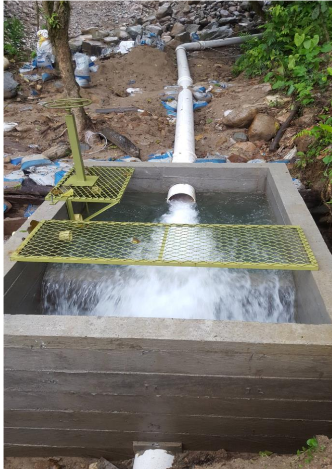
Figura 18. Tanque de derivación en funcionamiento
