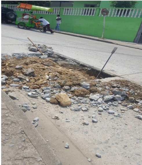
Figura 42. Primer apique para encontrar fuga.
