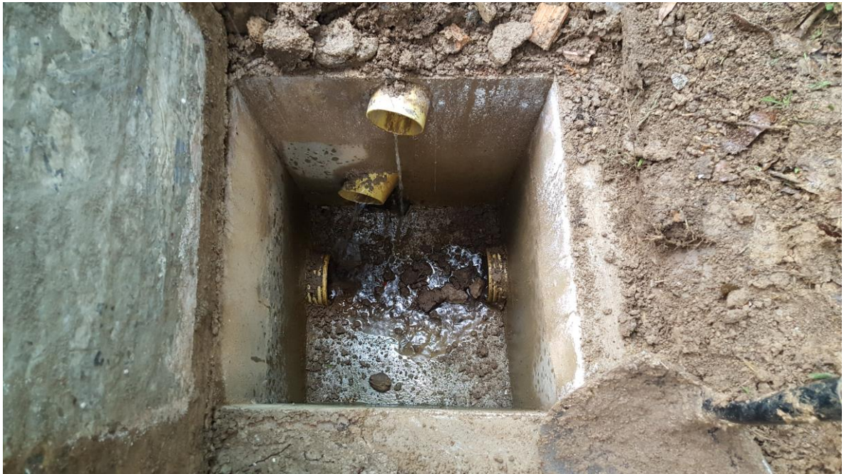
Figura 38. Cámara de inspección colegio Fidel de Montclar.
