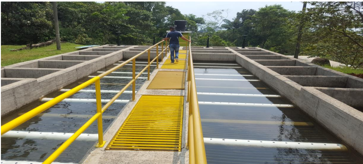
Figura 11. Planta de tratamiento agua potable Las Palmeras de Mocoa.
