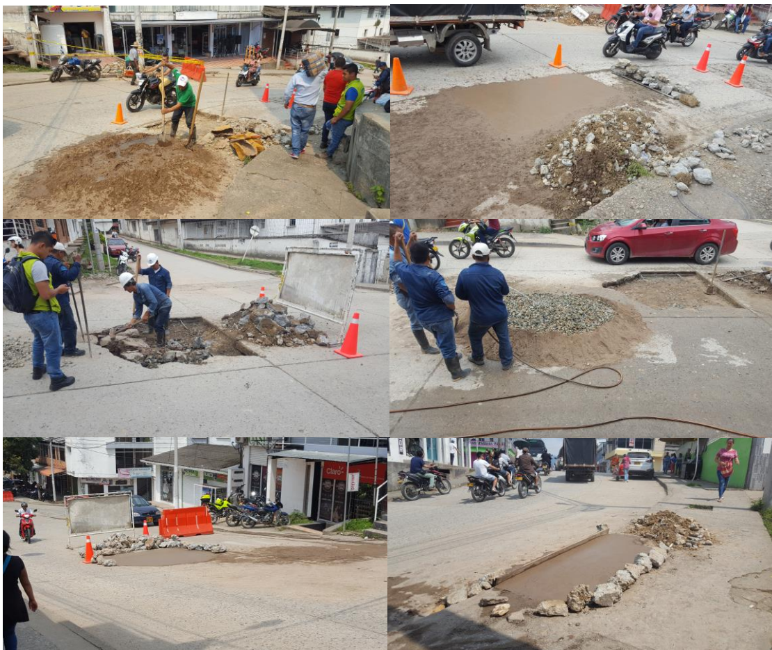
Figura 45. Collage de proceso de reparación zonas afectadas por la fuga de agua.
