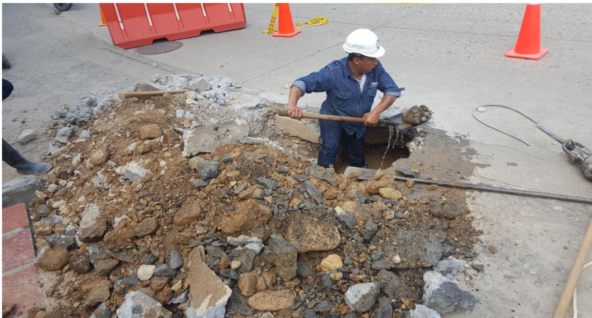
Figura 43. Segundo apique para encontrar fuga de agua.
