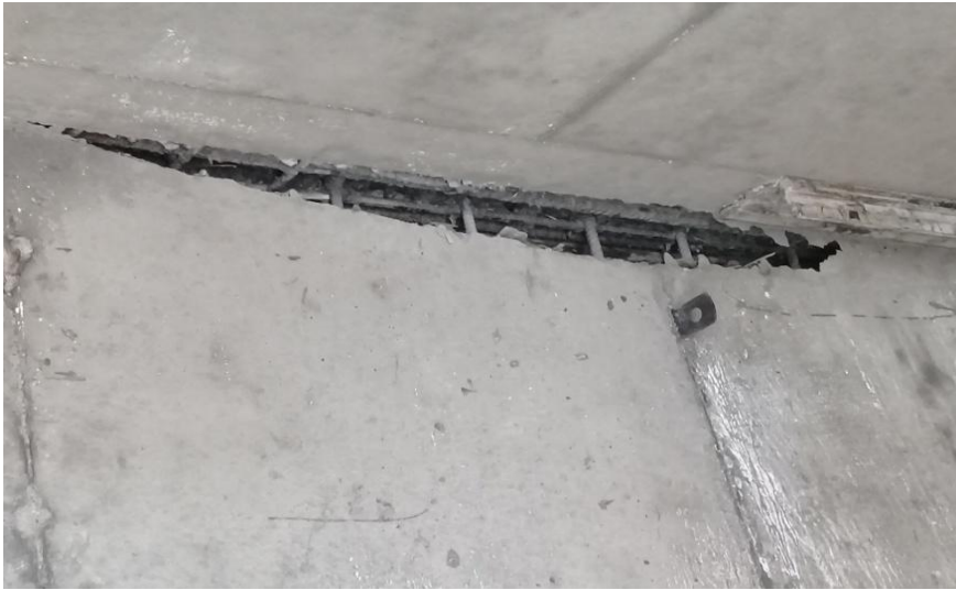
Fotografía 17: Vacio en el Muro 11. Fuente: autor.
