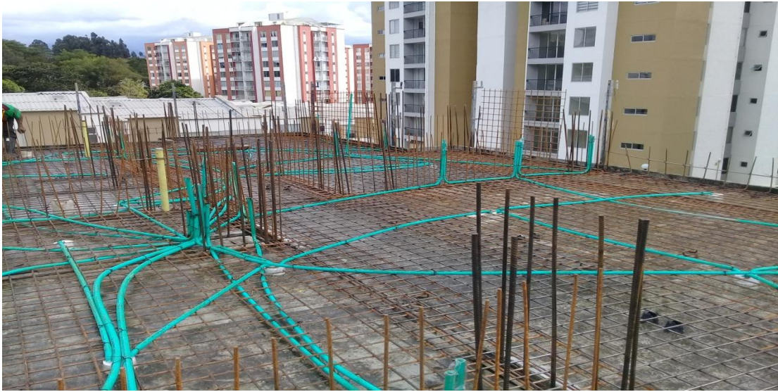
Fotografía 4: Tubería para cableado eléctrico. Fuente: autor.
