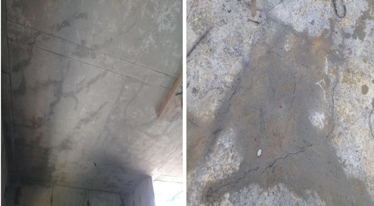
Fotografía 14: Losa de entrepiso parte inferior y superior. Fuente: autor.
