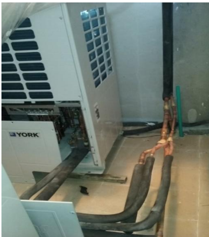
Figura 6.23 Conductos de conexión de unidades interiores con unidades exteriores de aire acondicionado
