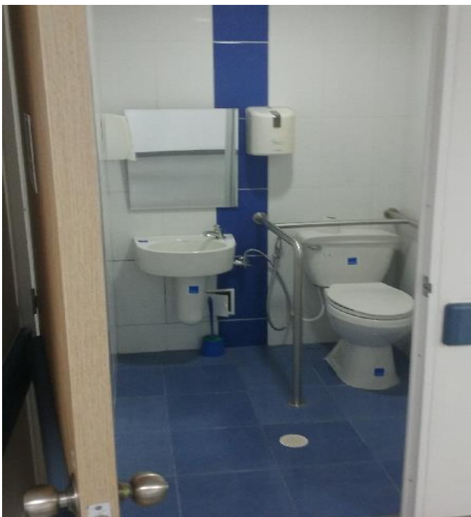
Figura 6.11 Lavamanos, sanitario, grifería push, botón de pánico y barra de seguridad (baño discapacitados)
