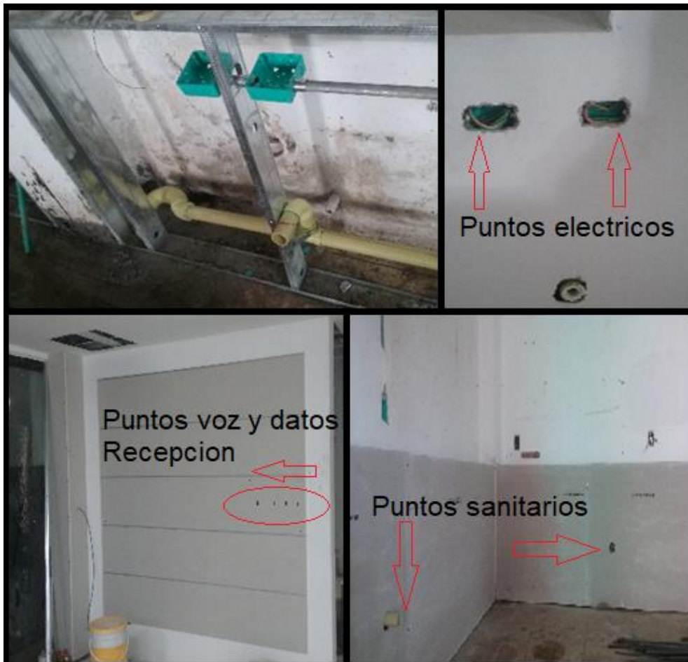
Figura 6.15 Pases para puntos sanitarios, hidráulicos, eléctricos, voz y datos en muros Drywall
