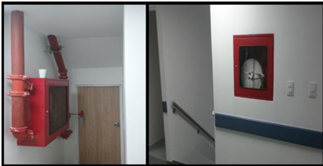
Figura 6.27 Gabinetes de la red contra incendios; primer y segundo piso
