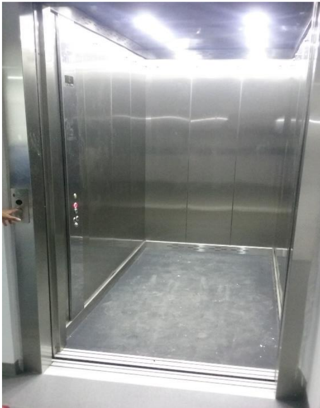
Figura 6.30 Ascensor tipo camillero
