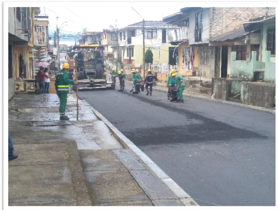
Ilustración 49. Operarios retirando el agua lluvia y realizando la unión de las mezclas asfálticas después de una fuerte lluvia
