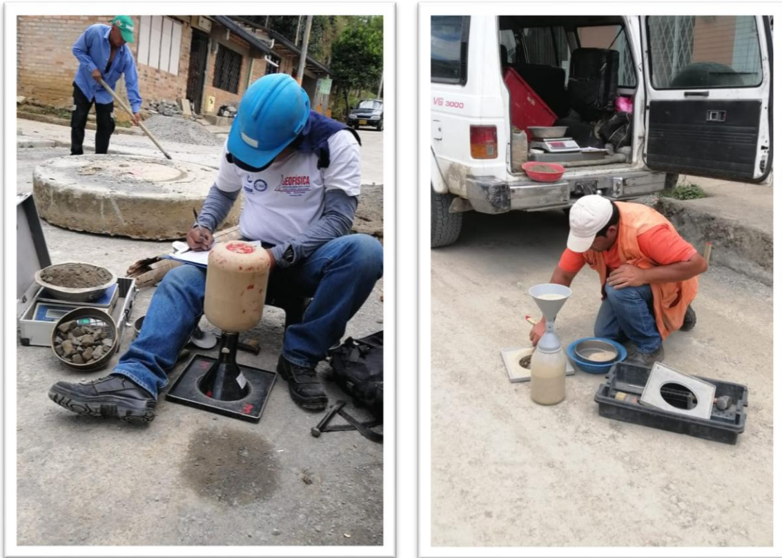
Ilustración 40. Toma de muestras a capa de base para ensayos de compactación, Barrio Las Veraneras y Barrio Junín
