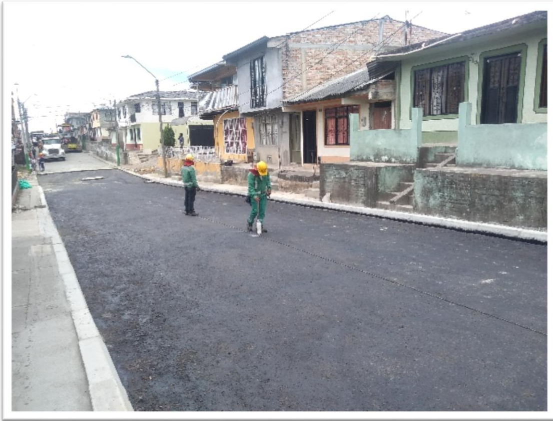
Ilustración 44. Marcación del eje de la vía para pavimentación en el Barrio Los Comuneros
