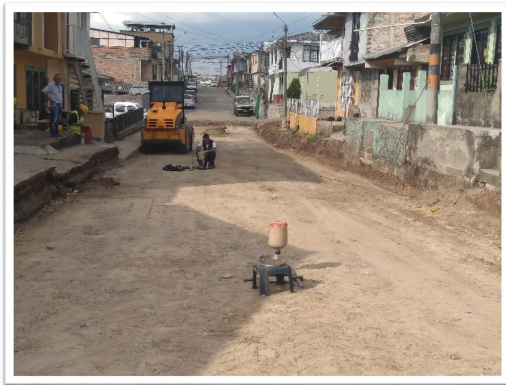
Ilustración 23. Toma de muestras a subrasante compactada para ensayos de compactación, Barrio Los Comuneros
