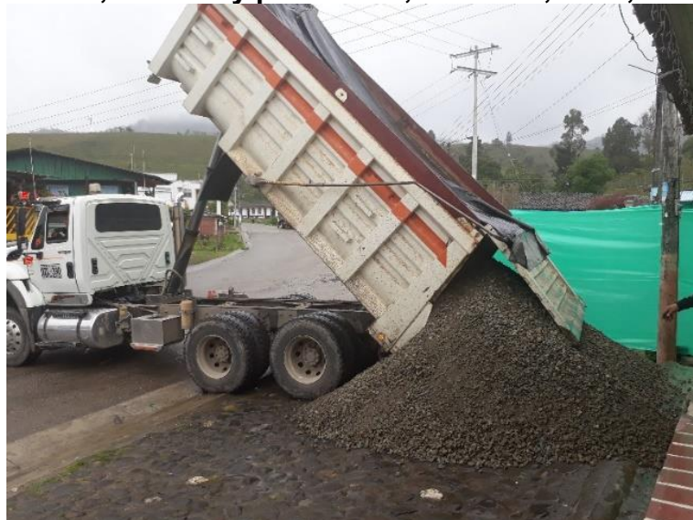
Figura 12. Transporte de materiales provenientes de la excavación de la explanación, canales y préstamos, afirmado, base, sub base.
