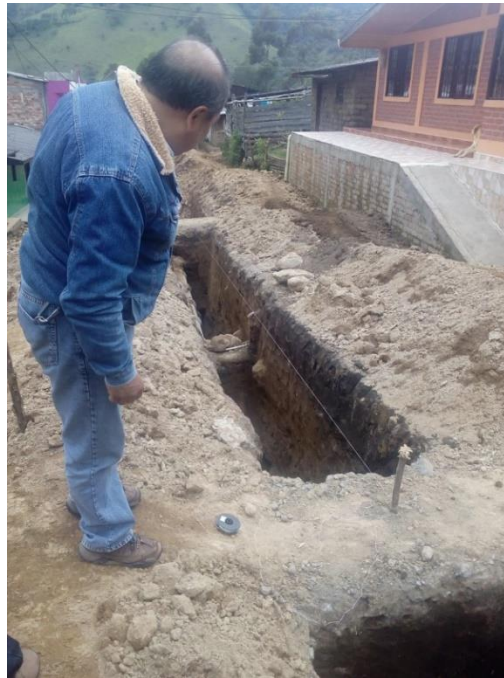
Figura 36 Inspección de Administrativos de la Alcaldía Municipal Purace-Coconuco
