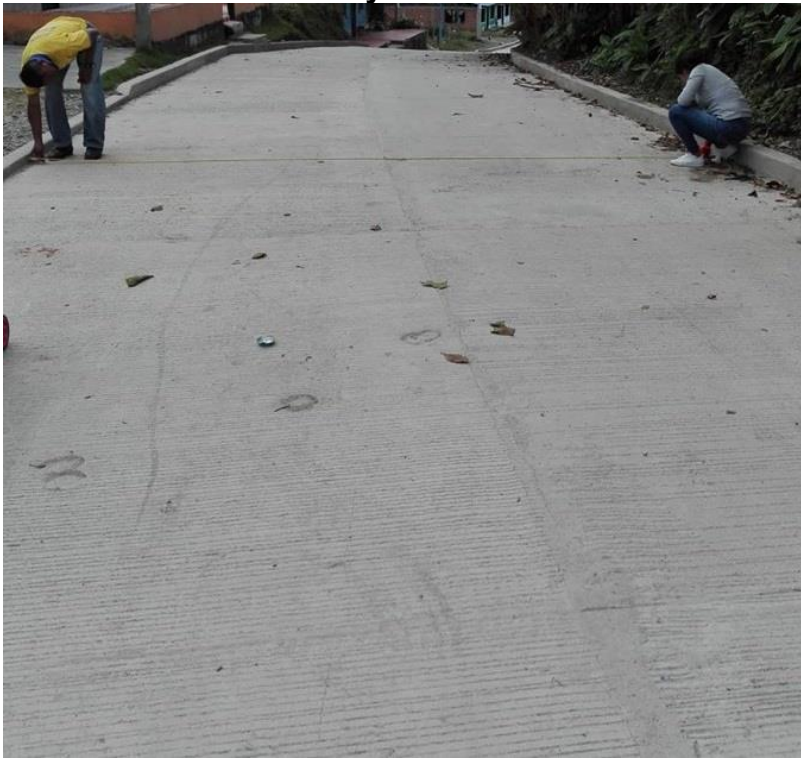
Figura 18. Detalle de inspección del pavimento rígido en la Cra 3 entre CII 2 y CII 3.
