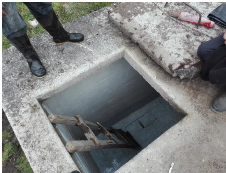
Figura 54. Evidencia visita realizada al sistema de abastecimiento de Pisanrrabó
