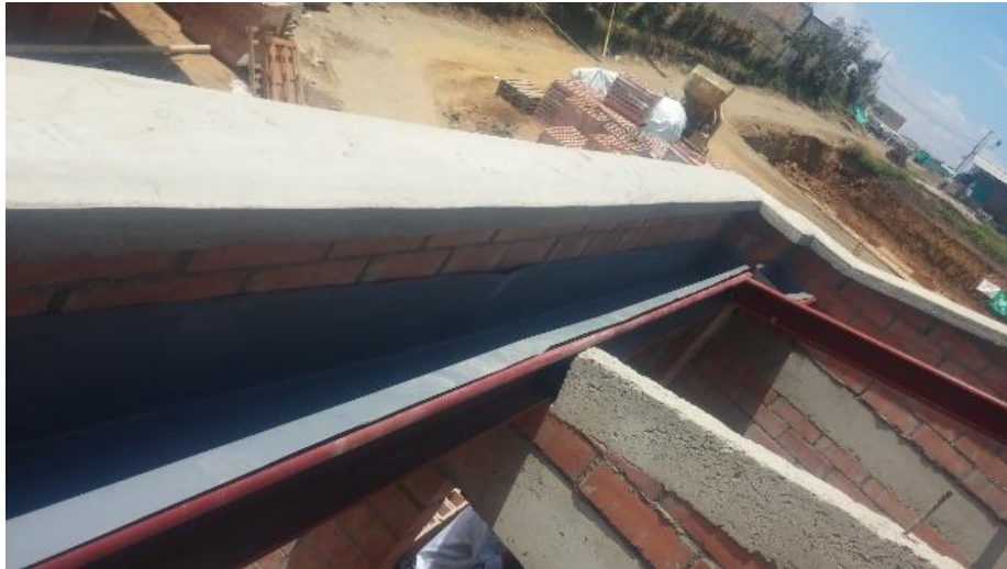
Figura No. 38. Canal en cubierta
