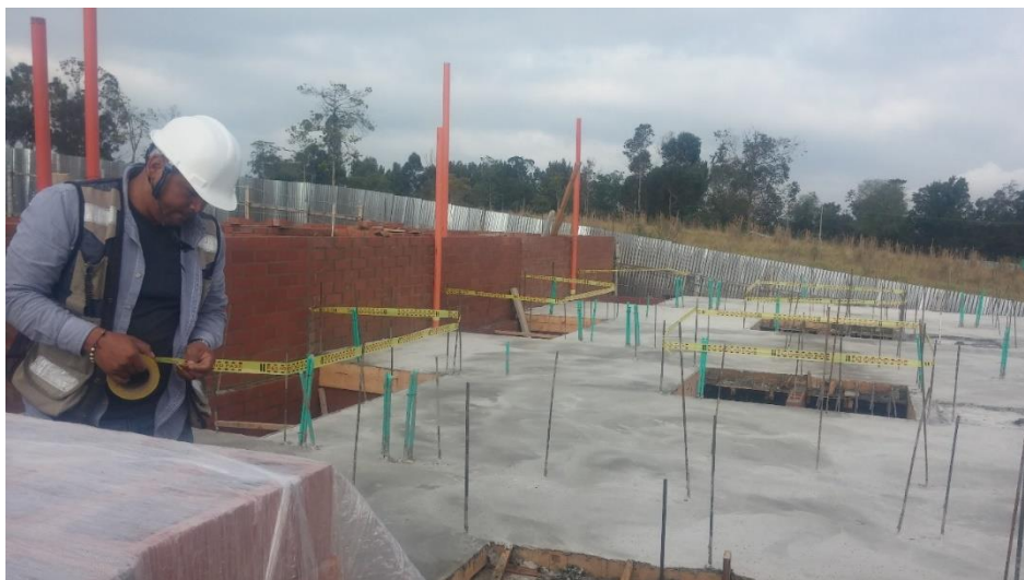
Figura No. 60. Demarcación zona de riesgo
