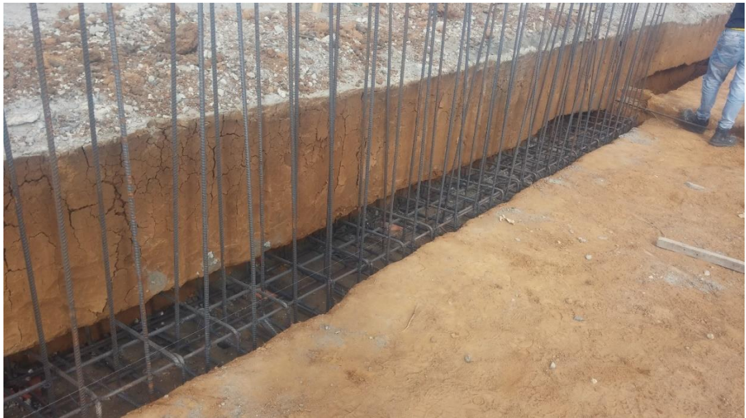
Figura No. 7. Castillo de acero instalado muro de contención para desnivel de casas
