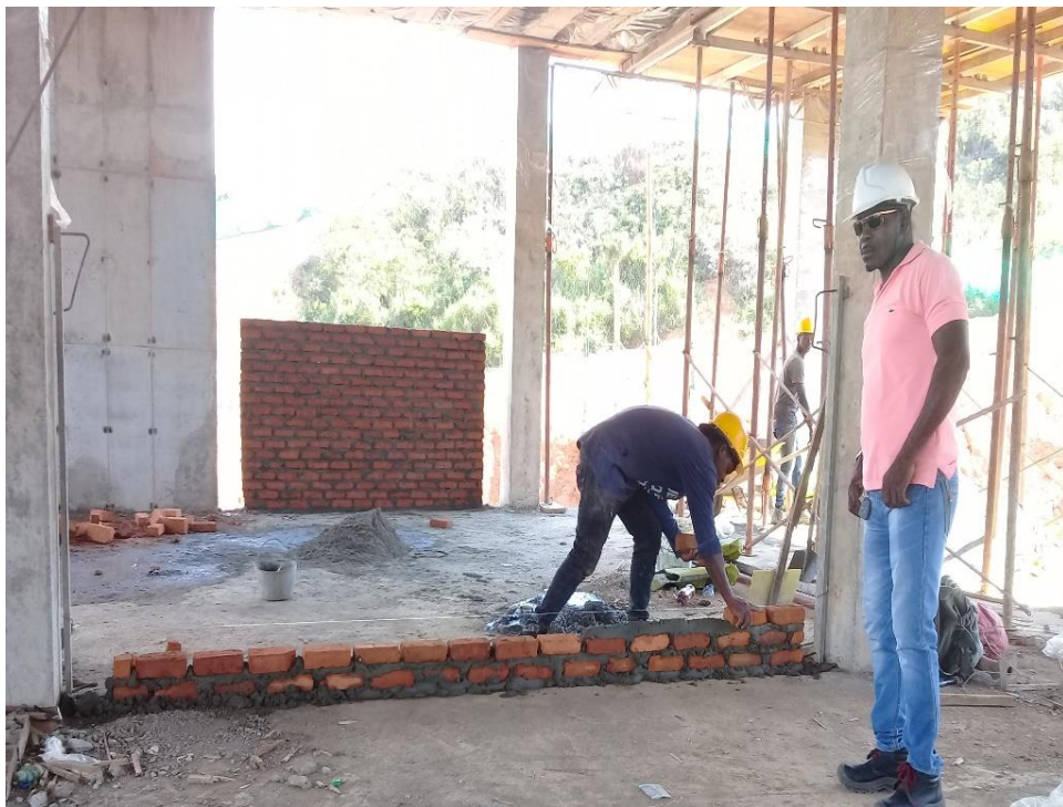
Ilustración 17. Pega de muros en el segundo piso bloque 1 y bloque 2 Fuente propia
