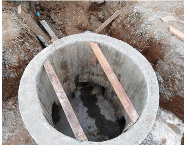
Ilustración 27. Cámara c11 fundida Fuente propia
