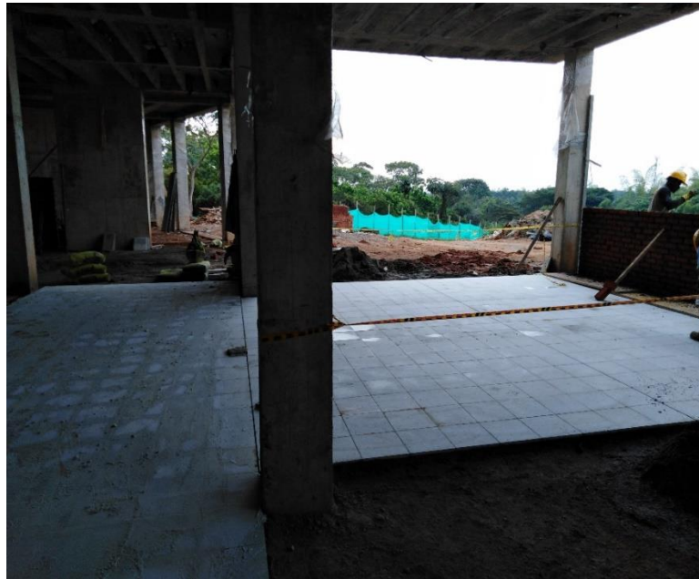
Ilustración 26. Baldosa pasillo entrada en el bloque 2
