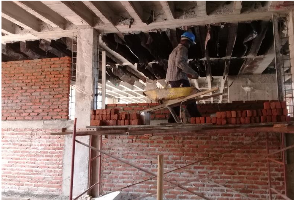
Ilustración 16. Estado inicial de algunos muros en el primer piso bloque 1 Fuente propia
