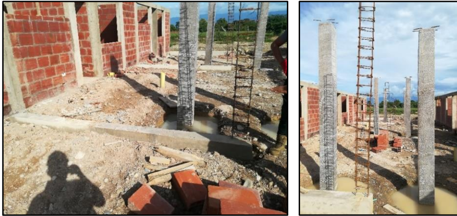
Fotografía 11: Área de zapata inundada
