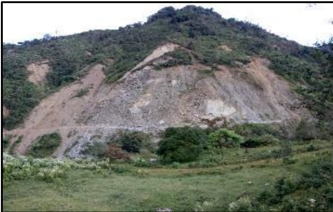
Figura 41. Sitio crítico PR79+0700, sector de Guanacas
