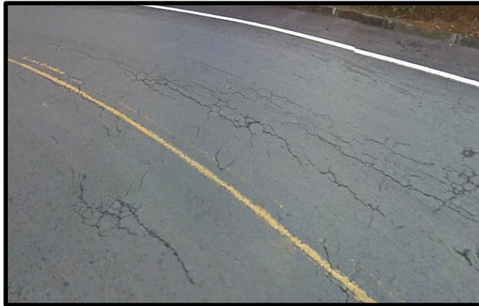
Figura 38. Daño estructural por fisura longitudinal
