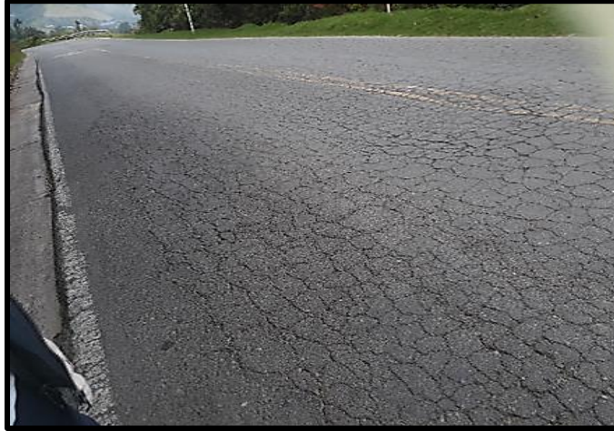
Figura 37. Daño estructural por fisura tipo piel de cocodrilo
