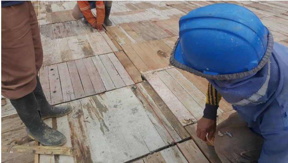
Figura 26. Demarcación de columnas o pantallas en construcción edificio INDETEC. 16 de noviembre de 2018
