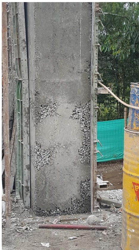
Figura 21. Hormigueros presentes en columnas de construcción edificio INDETEC. 31 de octubre de 2018
