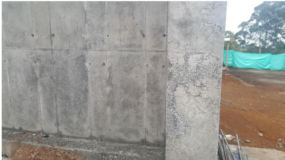
Figura 23. Hormigueros presentes en pantallas de construcción edificio INDETEC. 31 de octubre de 2018
