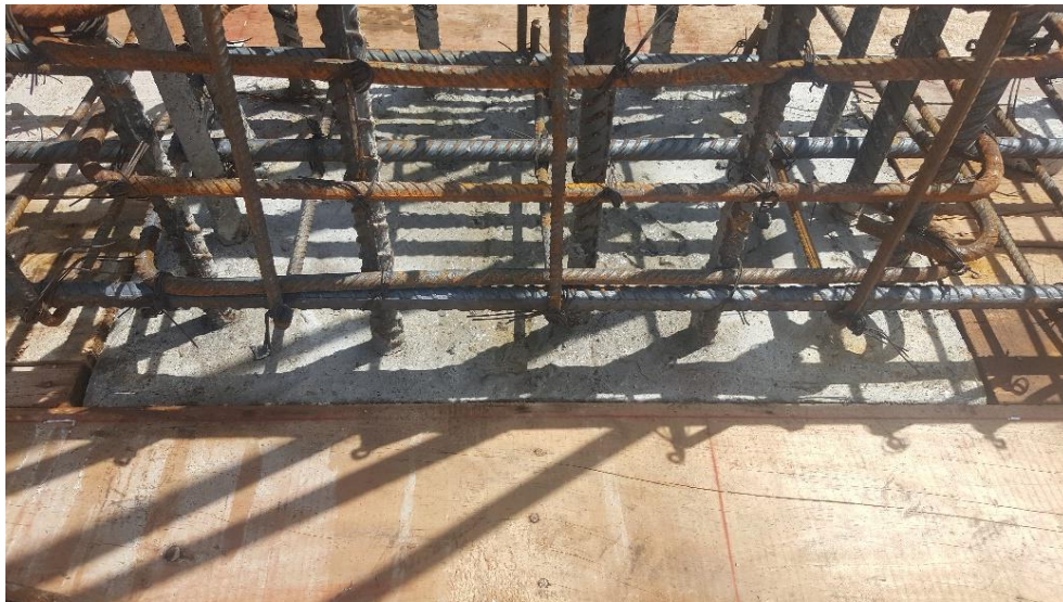
Figura 13. Demarcación de columnas o pantallas en construcción edificio INDETEC. 13 de octubre de 2018
