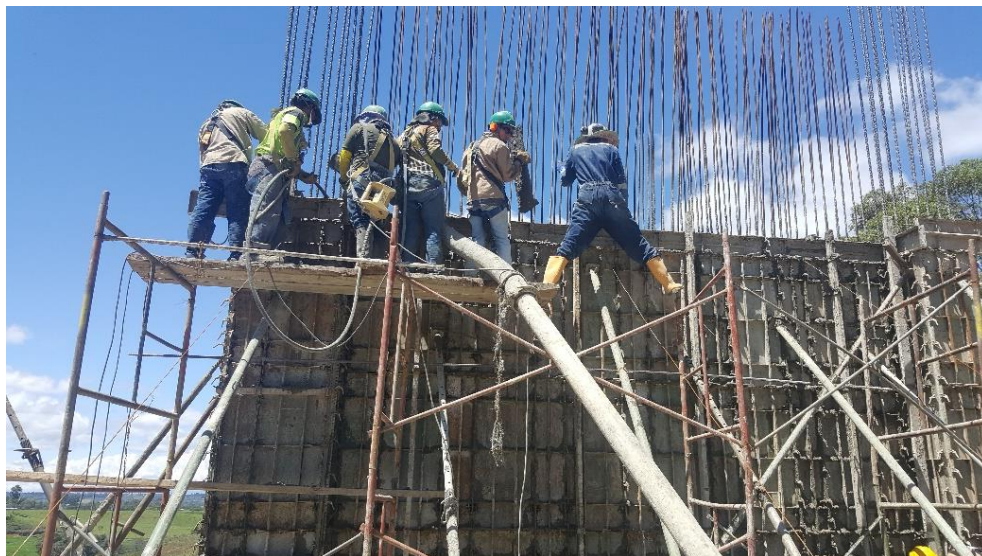
Figura 17. Fundición de pantallas de segundo piso en construcción edificio INDETEC. 6 de noviembre de 2018
