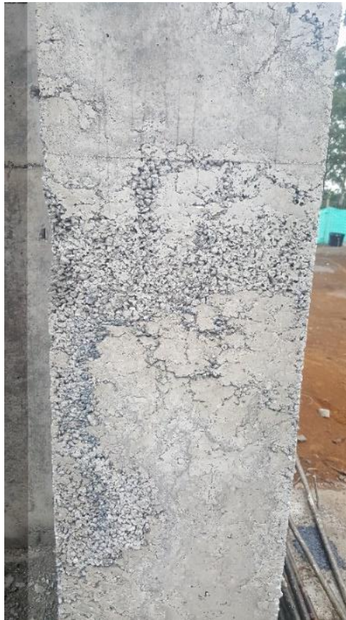
Figura 9. Hormigueros presentes en construcción edificio INDETEC. 9 de octubre de 2018
