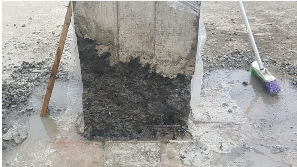
Figura 22. Hormigueros presentes en columnas de construcción edificio INDETEC. 31 de octubre de 2018
