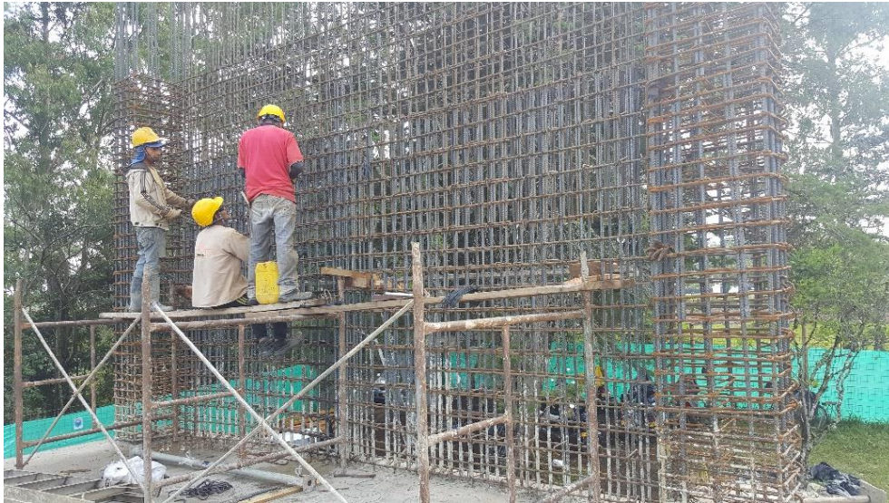
Figura 12. Revisión de aceros de pantallas en construcción edificio INDETEC. 13 de octubre de 2018
