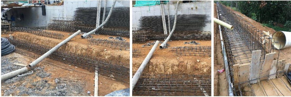
Figura N° 29. Colocación de Tubería para Bomba de Concreto y Amarrado Aceros de Zarpa y Muro, Muro de Contención Vía Interna. Fuente Propia.
