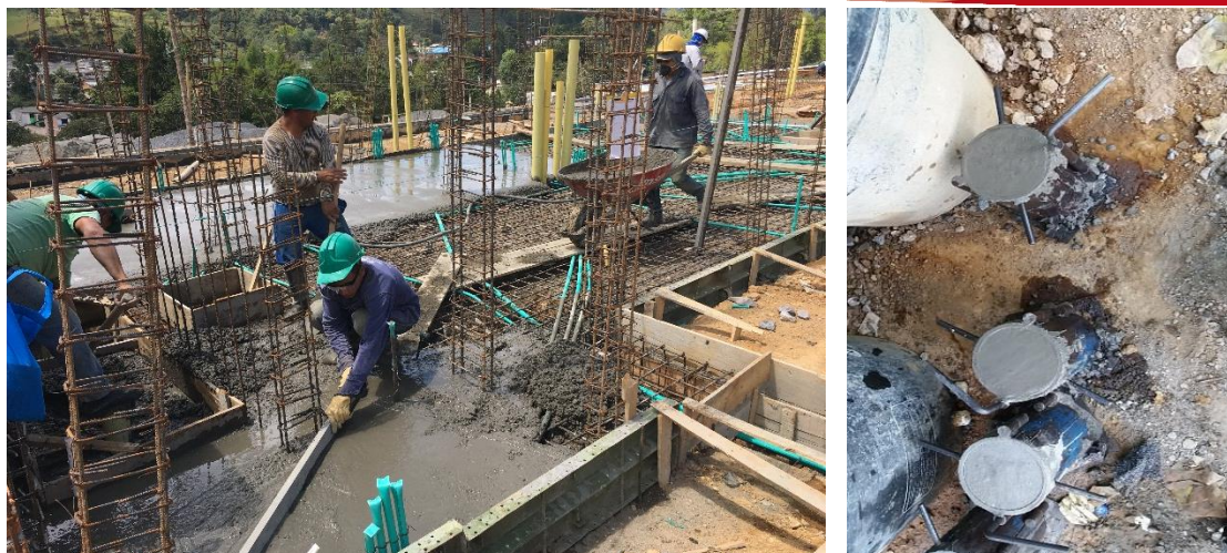
Figura N° 9. Fundición de losa de cimentación plana y Cilindros Testigo, Casas 10 y 11 Manzana C. Fuente Propia.
