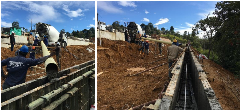
Figura N° 31. Fundición de Muro de Concreto, Muro de Contención Vía Interna. Fuente Propia.
