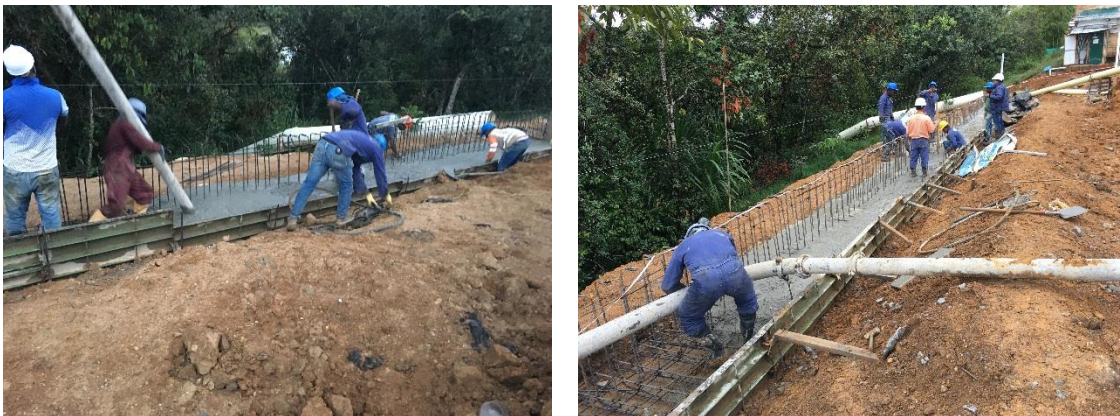
Figura N° 30. Fundición de Zarpa con Bomba de Concreto, Muro de Contención Vía Interna. Fuente Propia.
