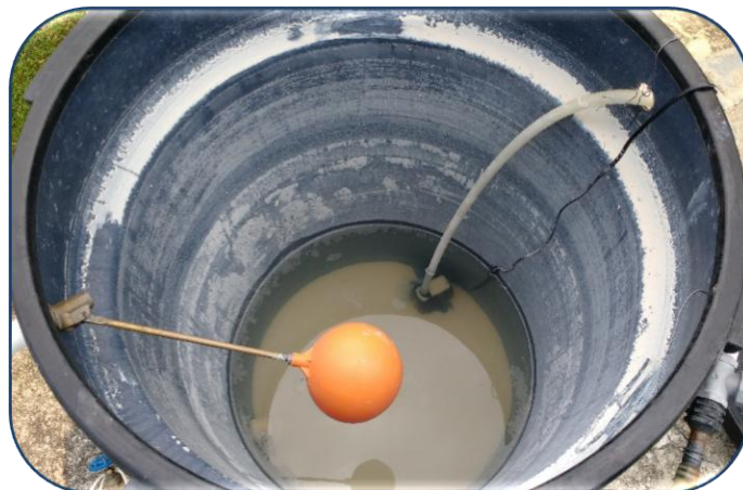
Figura 36. Sedimentos en el tanque de 250 litros al final de un ciclo de desinfección
