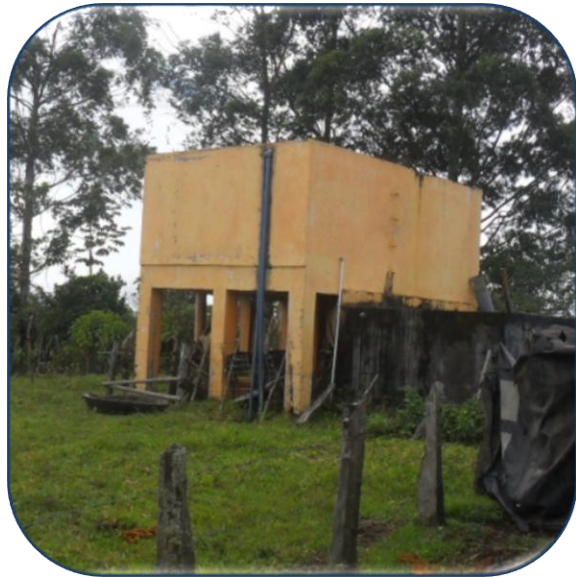
Figura 6. Tanque de almacenamiento
