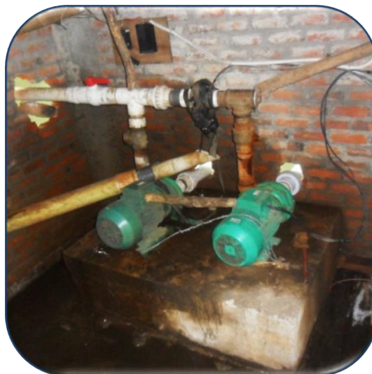
Figura 8. Motobombas instaladas en la estación de bombeo
