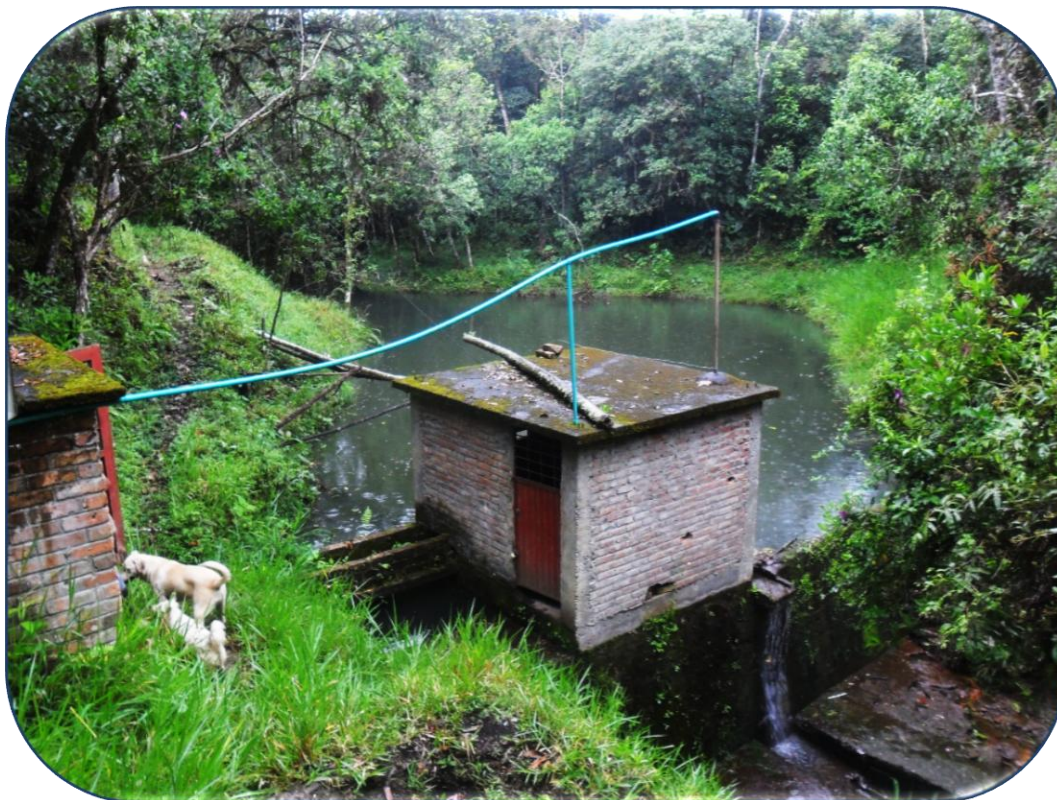
Figura 5. Embalse sobre la quebrada El Cedro y estación de bombeo
