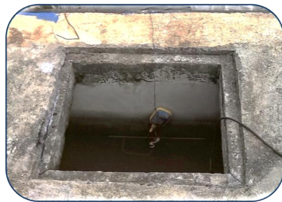
Figura 7. Interruptor de nivel instalado en el tanque de almacenamiento
