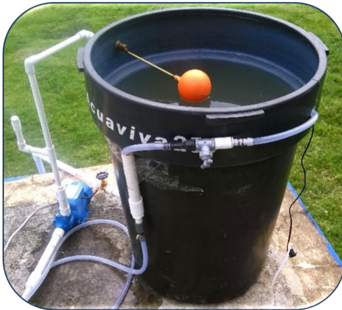
Figura 31. Arranque del sistema de desinfección
