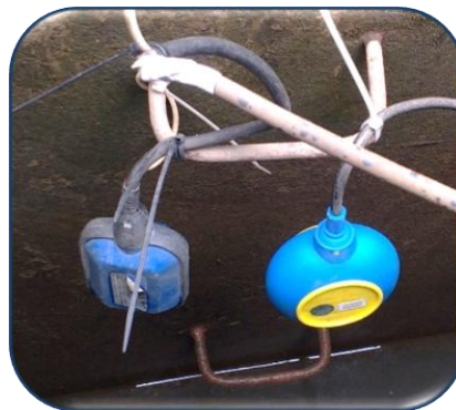
Figura 29. Interruptores de nivel en el tanque de almacenamiento
