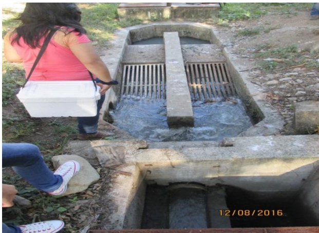
FIGURA N°8 ALIVIADERO Y CÁMARA DE CRIBADO.
