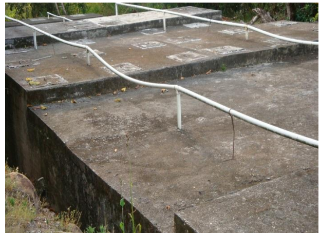
FIGURA N° 9. TANQUE SÉPTICO Y FAFA
