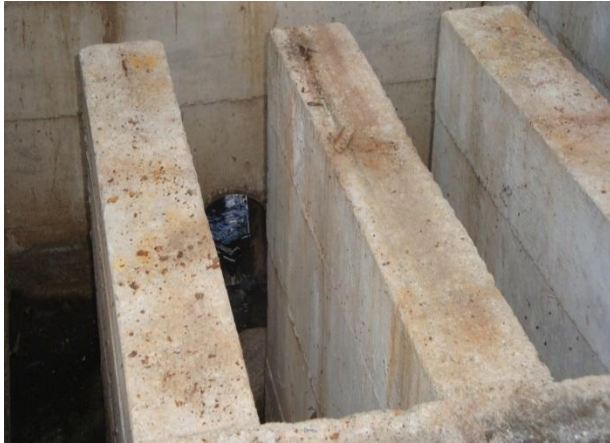
FIGURA N°10. CÁMARA DE REPARTO.
