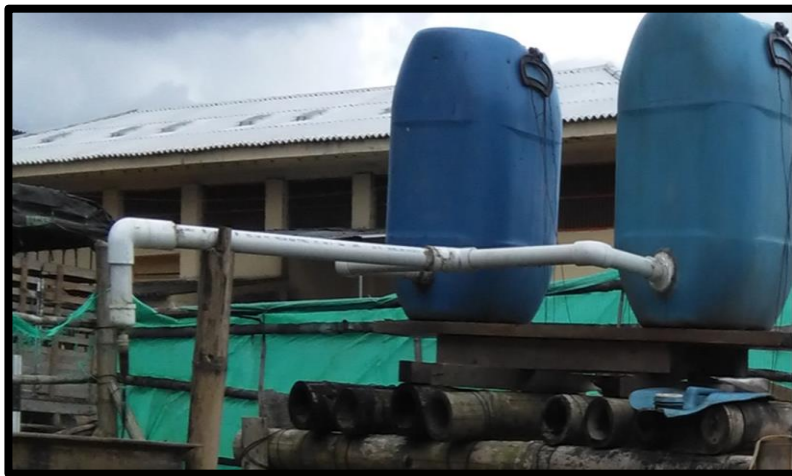
Foto 6. Macro goteo a la salida de la tubería de 1". De tanque de almacenamiento a sedimentador.
