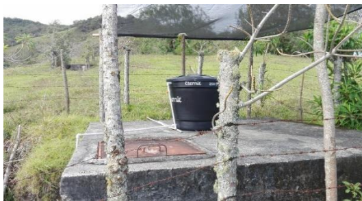
Sistema de cloración, Pisojé Bajo, Popayán
