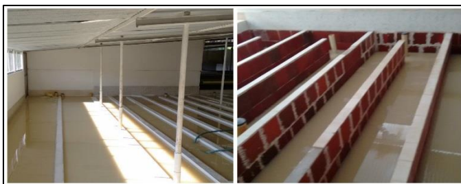
Figura 6. Canales de sedimentación.
