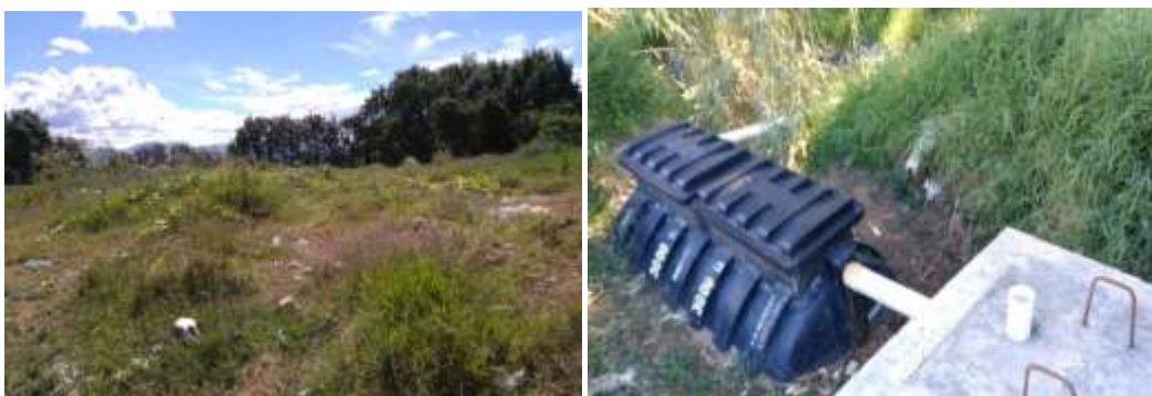
Figura 18. a) Celda con cobertura b) Sistema de tratamiento de lixiviados de la celda
