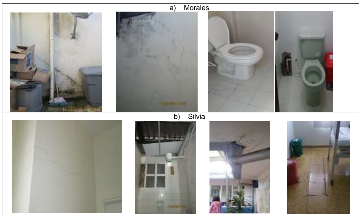
Figura 12. Estado de la infraestructura en Morales y Silvia
