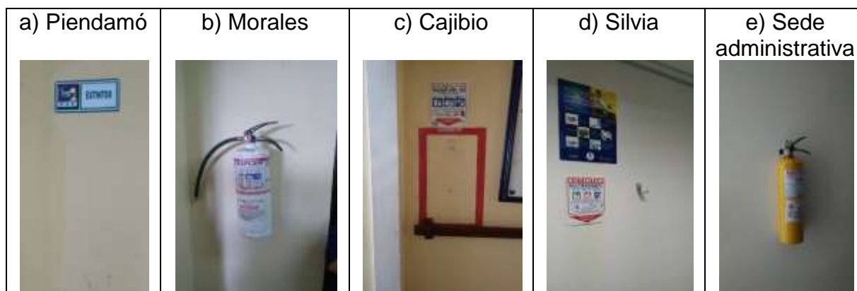
Figura 14 Carencia de extintores y señalización de los mismos en los cuatro Puntos de Atención de la ESE
