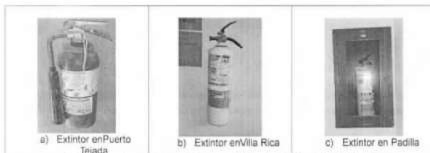
Figura 10. Carencia de extintores en los Puntos de Atención de la ESE
