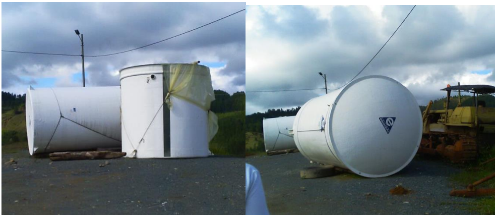
Figura 11 y 12: Tanques de tratamiento, relleno sanitario Los Picachos Fuente: Propia (19/01/2018)
