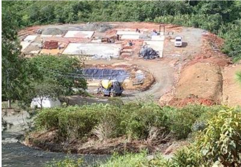
Figura 10: Losas construidas para soporte de tanques de tratamiento, relleno sanitario Los Picachos Fuente: Propia (19/01/2018)
