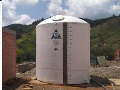
Figura 19: Tanque Retrolavado (Floculación sedimentación de manto de lodos), relleno sanitario Los Picachos Fuente: SERVIASEO S.A (13/02/2018)
