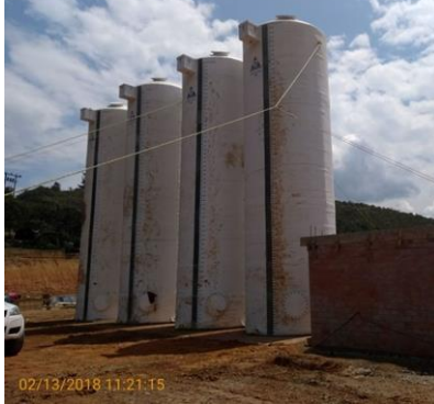
Figura 15: UASB, relleno sanitario Los Picachos Fuente: SERVIASEO S.A (13/02/2018)
