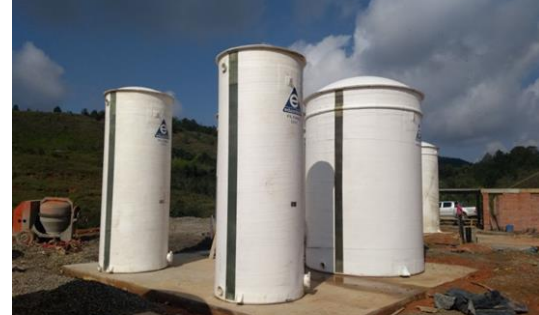
Figura 18: Filtros y FSML (Floculación sedimentación de manto de lodos), relleno sanitario Los Picachos Fuente: SERVIASEO S.A (13/02/2018)
