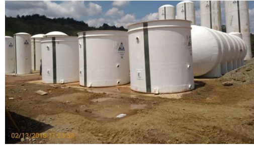
Figura 14: Clarificador, relleno sanitario Los Picachos Fuente: SERVIASEO S.A (13/02/2018)
