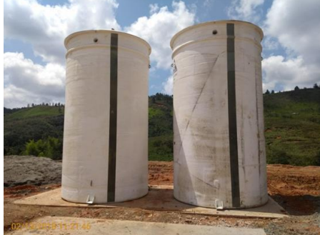
Figura 17: Espesador de lodos, relleno sanitario Los Picachos Fuente: SERVIASEO S.A (13/02/2018)
