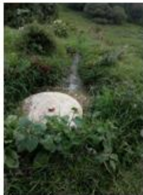
Imagen 1. Cámara de inspección con rebosa de aguas (a)
