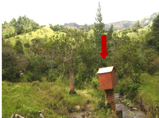
Figura 11. Caseta con estación hidrométrica, sin funcionamiento (F 6 , ver Anexo E)
