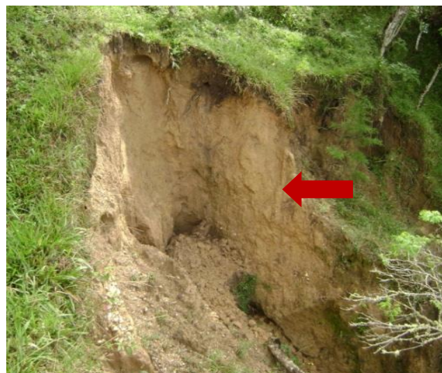
Figura 16. Derrumbe (F 11 , ver Anexo E)
