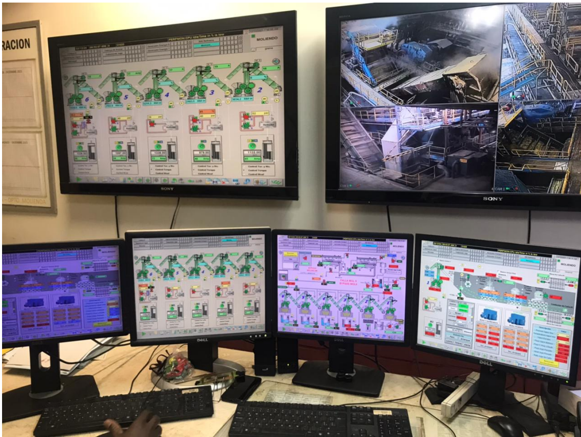
Figura 3.35: Cuarto de ingeniería Ingenio La Cabaña S.A Fuente: Ingenio la Cabaña
