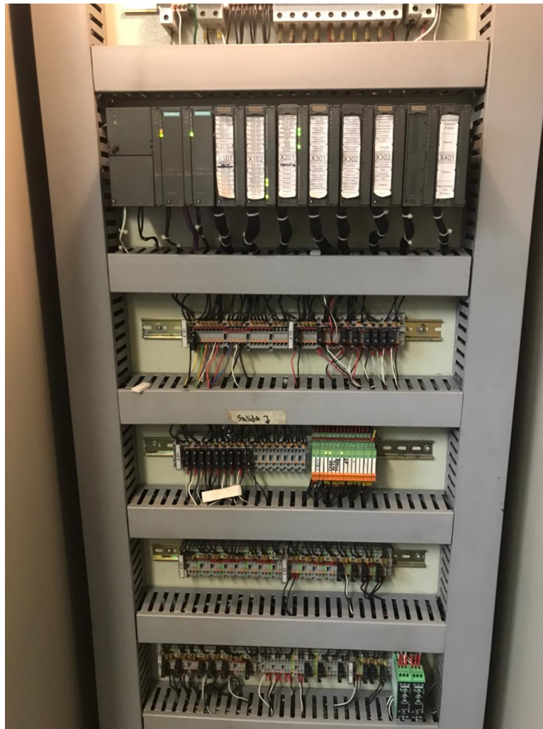
Figura 3.13: Tablero de señales área de elaboración Fuente: Propia
