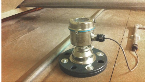
Figura 3.14: Configuración de transmisor indicador de nivel tipo radar Fuente: Propia
