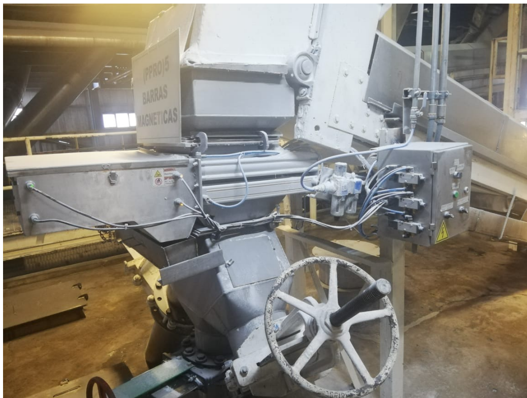
Figura 3.16: Montaje de sistema rejillas magnéticas Automático/Manual Fuente: Propia
