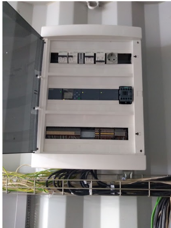
Figura 5.7: Tablero de automatización industrial en planta
