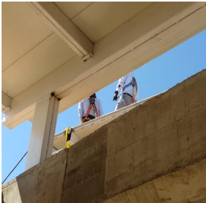
Ilustración 12: Trabajadores instalando los perfiles metálicos con el arnés de seguridad en la batería número uno. Fuente: propia
