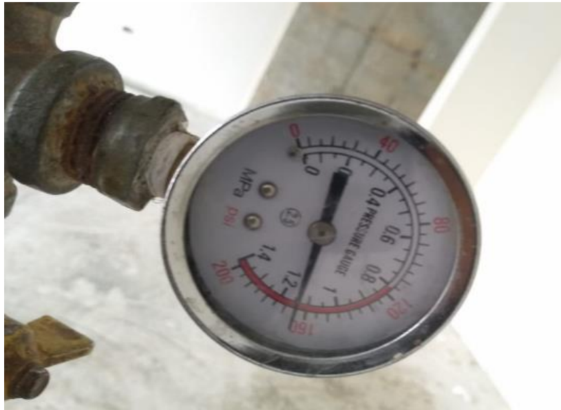
Ilustración 20: Manómetro utilizado para medir la presión en la prueba de estanqueidad. Fuente propia.
