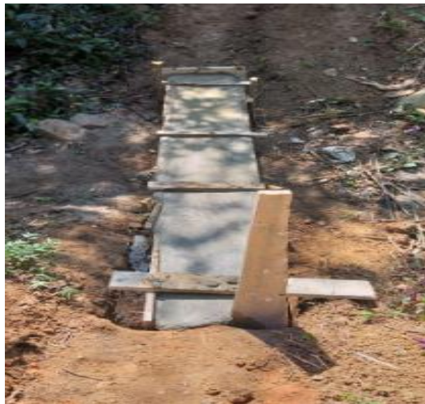
Ilustración 16: Anclaje de tubería en concreto de zona expuesta donde va una válvula de purga.
