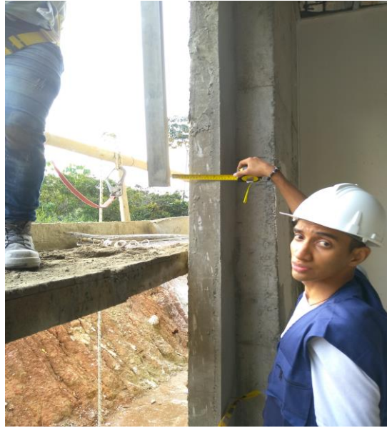
Ilustración 4: Desplome del muro reflejado al momento de aplicar el repello exterior Fuente: propia
