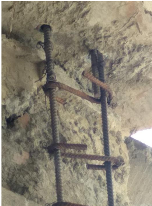
Ilustración 5: Error en la longitud de traslape de la varilla de 3/8" Fuente: propia
