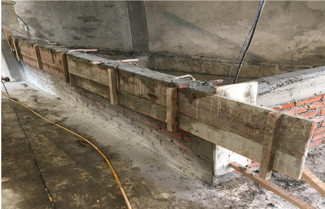
Ilustración 8. Vigüeta fundida, bloque 1, piso3.
