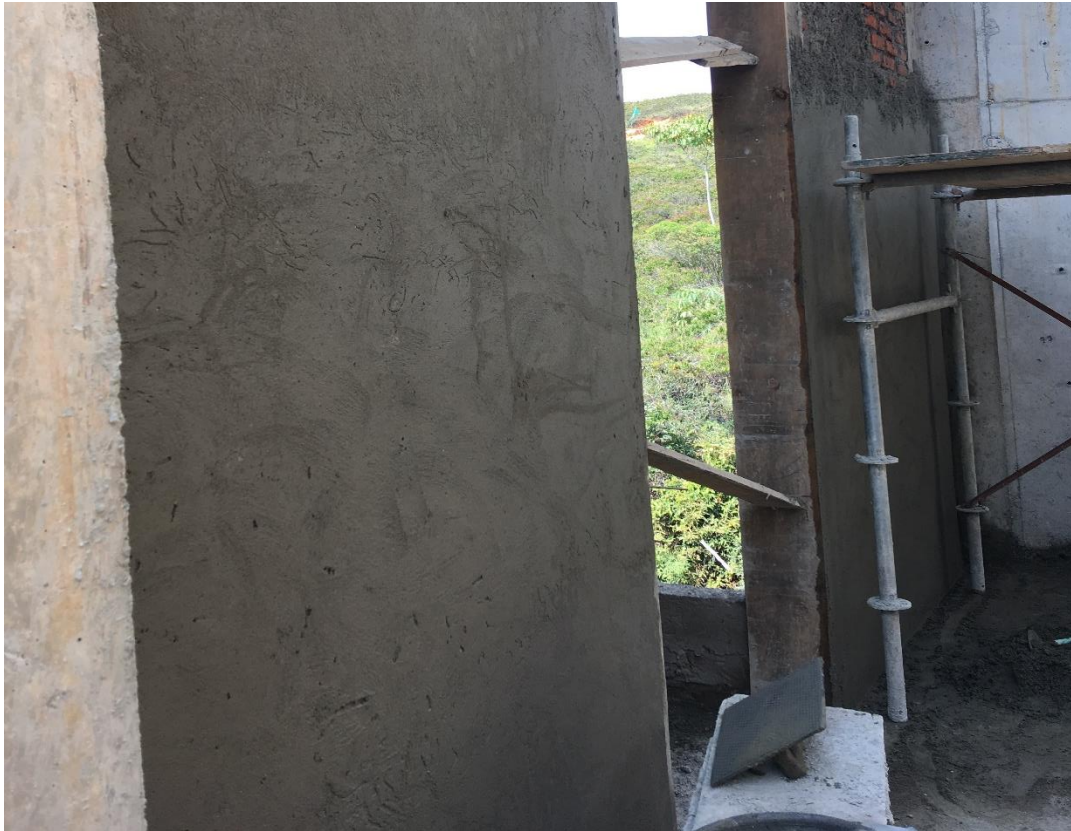
Ilustración 10. Repello en batería sanitaria 2 – piso 3.
