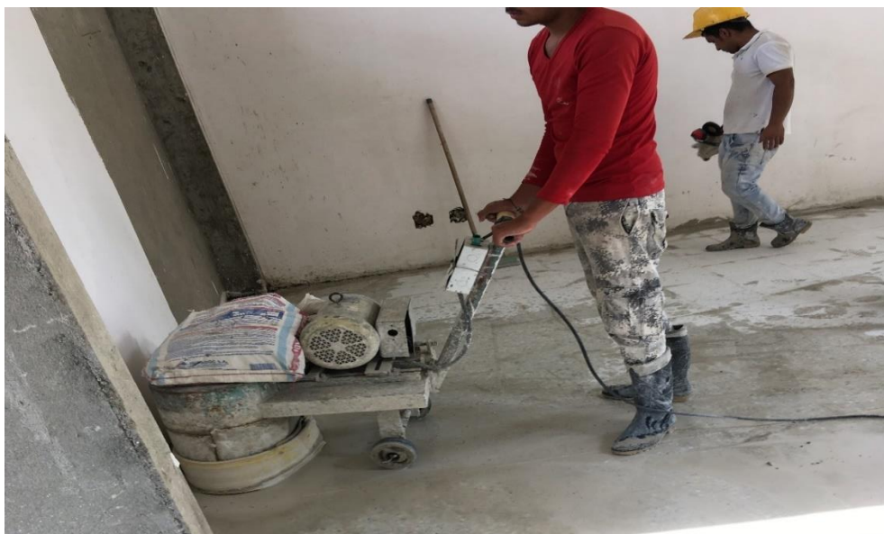
Ilustración 15. Destronque de baldosa en aulas.
