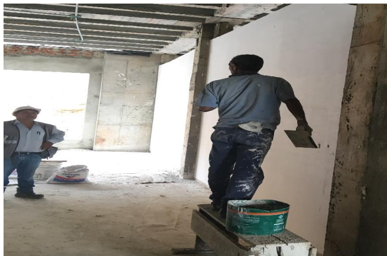
Ilustración 35. Estuco en superficie de muros de aulas.
