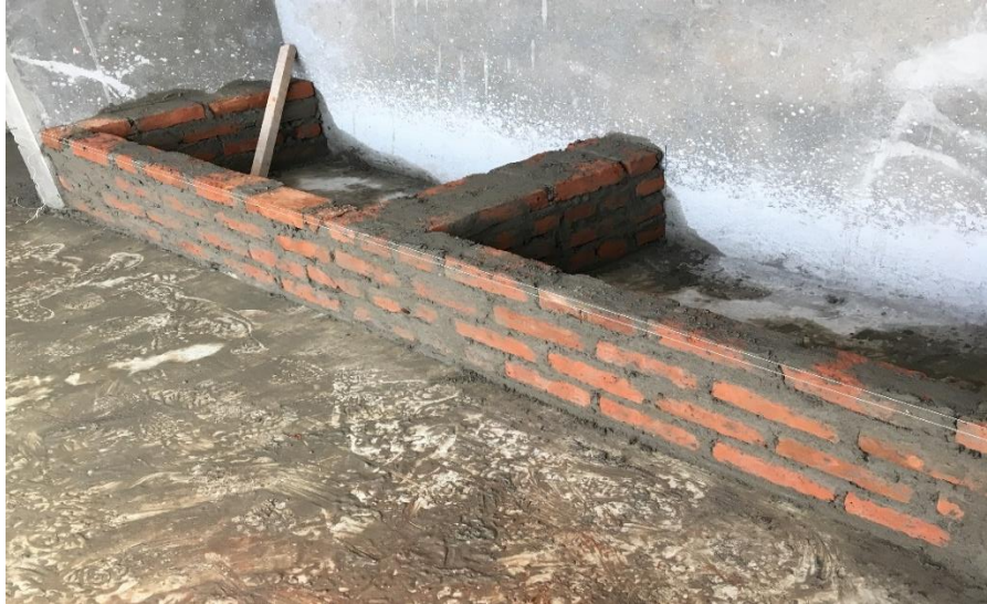
Ilustración 20. Muros bajos para soporte de losa para bancas en pasillo bloque 1 - piso 2.
