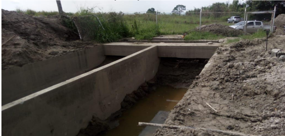
Figura 61. Foto del desarenador principal del acueducto Padilla (Padilla-Cauca).
