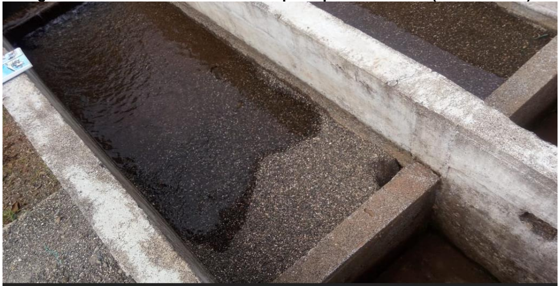
Figura 54. Foto filtro dinámico PTAP principal de la Sierra (Sierra-Cauca).
