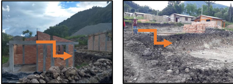
Figura No. 28 Viviendas que requerían construcción de muros.
