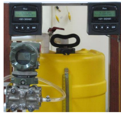
d) Transmisores: nivel y caudal
