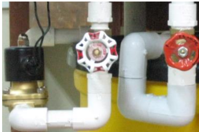
e) Electroválvula y válvulas manuales de disturbio y bypass
