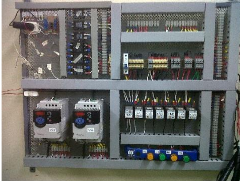
Figura 11. Tablero de Control
