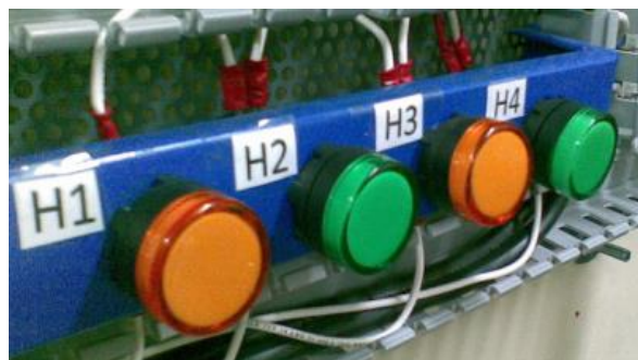
Figura 23. Luces piloto del tablero de control
