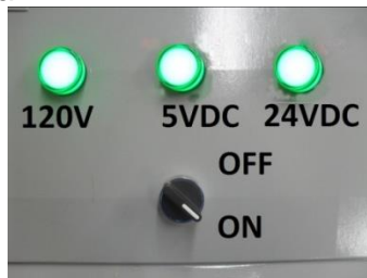
Figura G.3 Selector de encendido del sistema de clasificación en el panel HMI y pilotos de fuentes de alimentación eléctrica.
