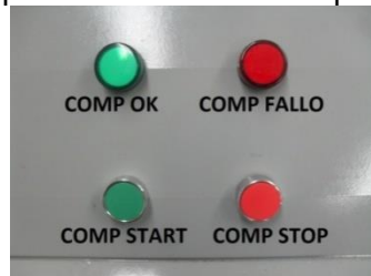
Figura G.6 Pulsadores y pilotos para el mando del compresor en el Panel HMI
