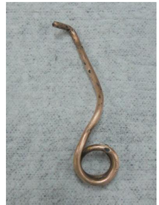
Figura 2.52. Cable polo a tierra.
