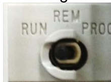
Figura 6. Switch Program-Run en el PLC
