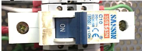
Figura 4. Breaker en posición ON
