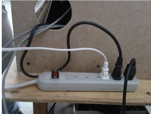
Figura 37. Multítoma ubicado en la parte trasera del cajón
