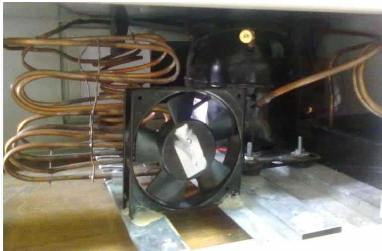
Figura 13. Compresor y condensador
