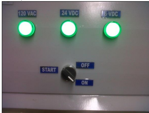
Figura C. 4 Encendido de la planta desde el HMI.
