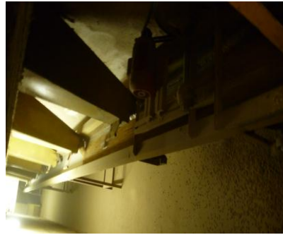
a) Banda transportadora de cárcamos
