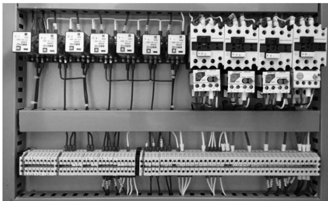
Figura 13. Elementos de potencia y borneras de salida.
